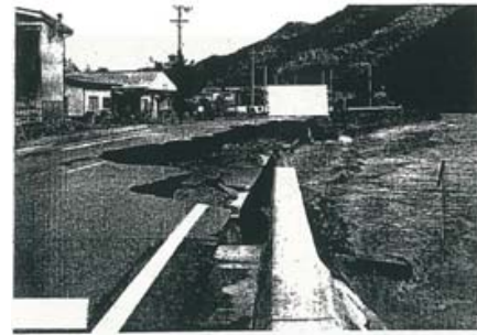
写真-1 基礎からの破壊例
