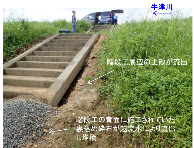
図-3 階段工周辺の侵食状況
