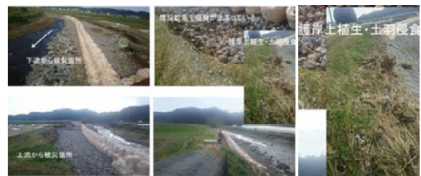
図-8 セグメント1侵食による決壊・破堤と護岸上部のり面の侵食
