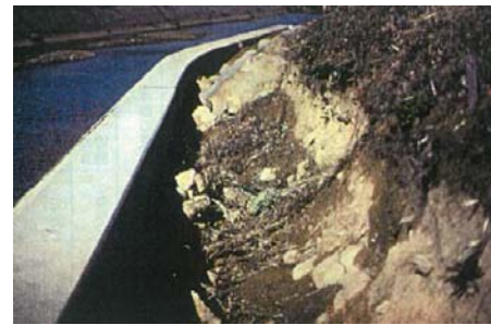
写真-2 計画高水位超過洪水による法肩侵食 (セグメントM)
