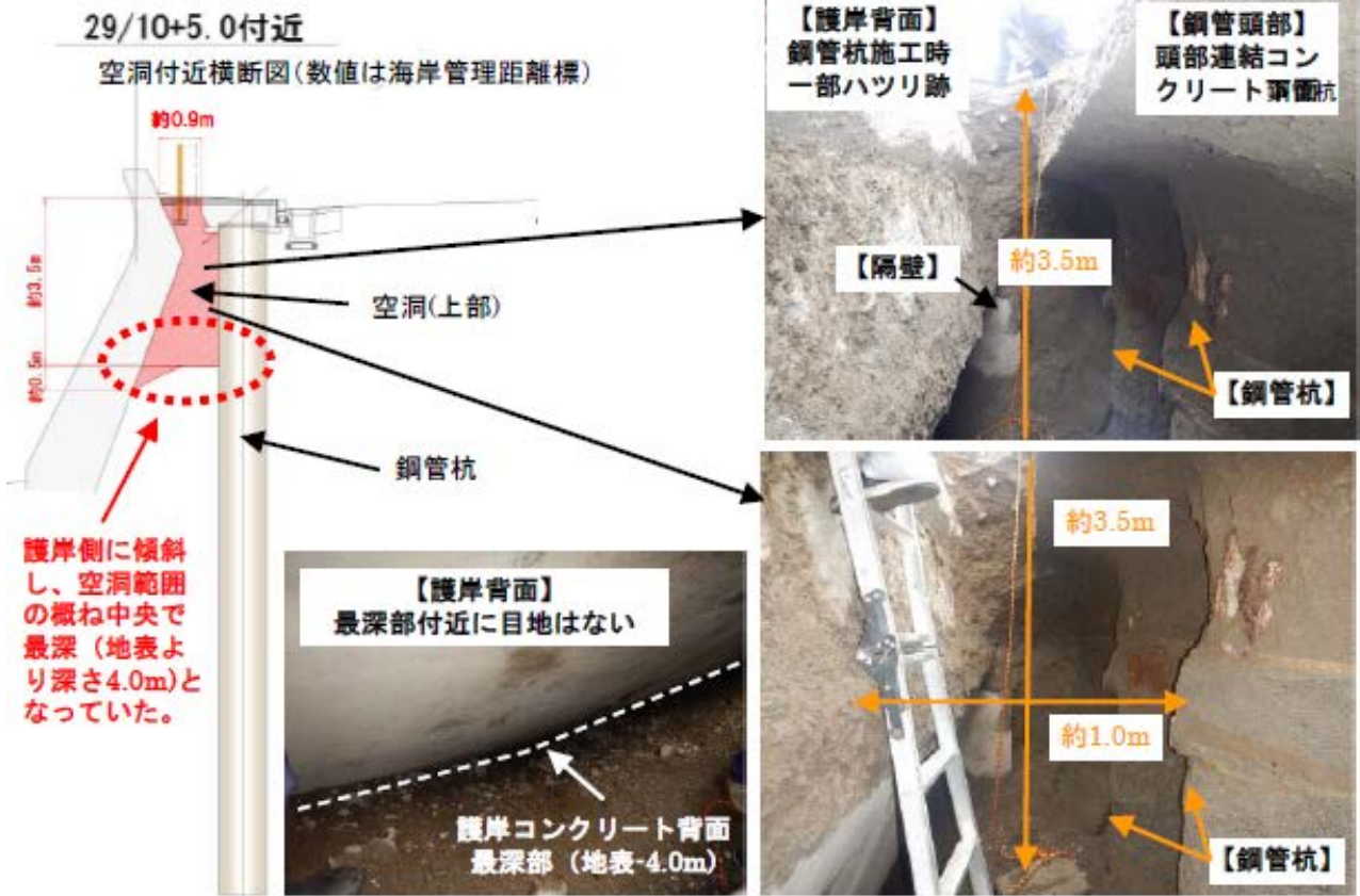
図-3 今回確認された空洞（上部）の状況
