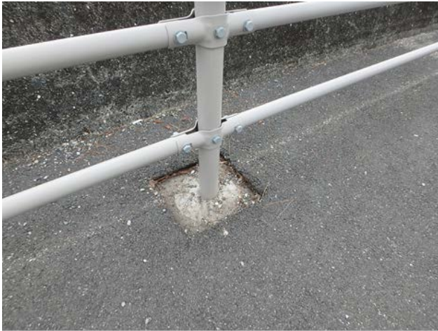
図-1 発見時の状況（転落防止柵の基礎がわずかに沈下）
