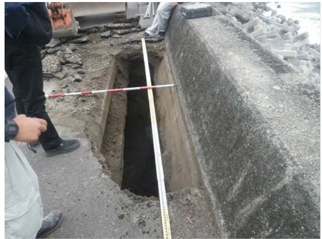
図-2 開削し空洞を発見した際の様子
