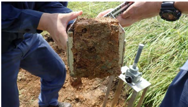
図-9 堤体土の礫混在状況(牛津川左岸12.2k)
