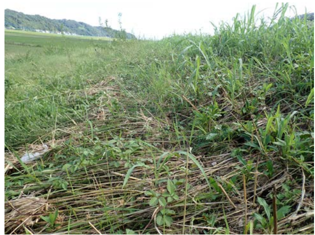
図-10 堤防川裏の植生繁茂状況(牛津川左岸12.2k)
