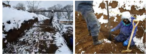
写真 1 ニツ森川試料の破堤箇所と試料採取状況
