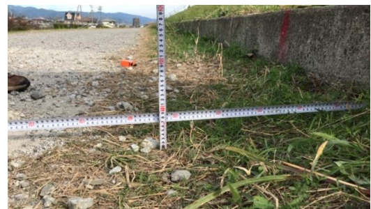
写真 2 2018/11 の陥没孔周辺の沈下状況
