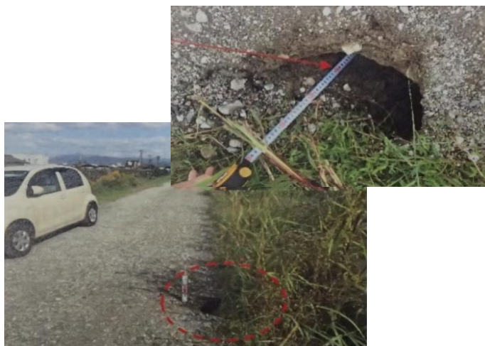
写真1 小段上の陥没孔 (2017/9 松山河川国道事務所)
