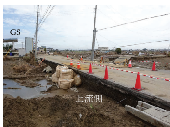
写真—5 決壊していないGSの南側の道路舗装
