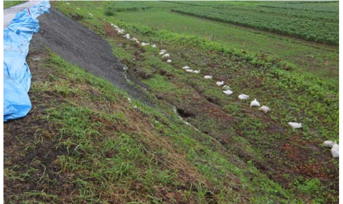
図-1 子吉川右岸 10.8km ののりすべりの状況 (応急復旧後で、欠損部には碎石充填済み)
