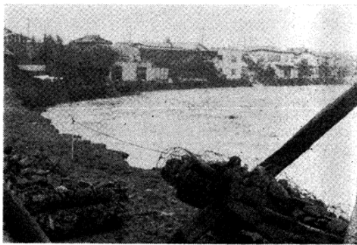
図-8 狛江地区の多摩川堤防決壊状況 13)
