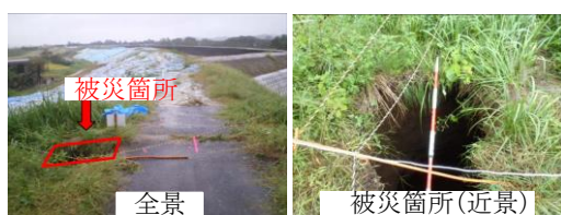
図-1 樋門周辺地盤に発生した空洞 1)
