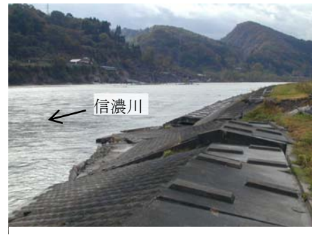
図-10 越の大橋付近の低水敷護岸の変状(新潟県中越地震 10) )
