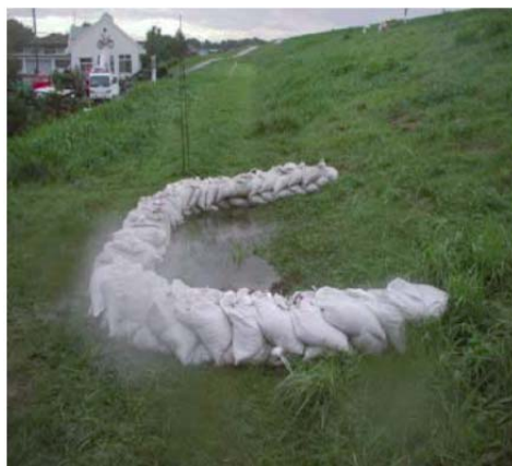
図-1 加須市の堤防裏漏水状況 2)
