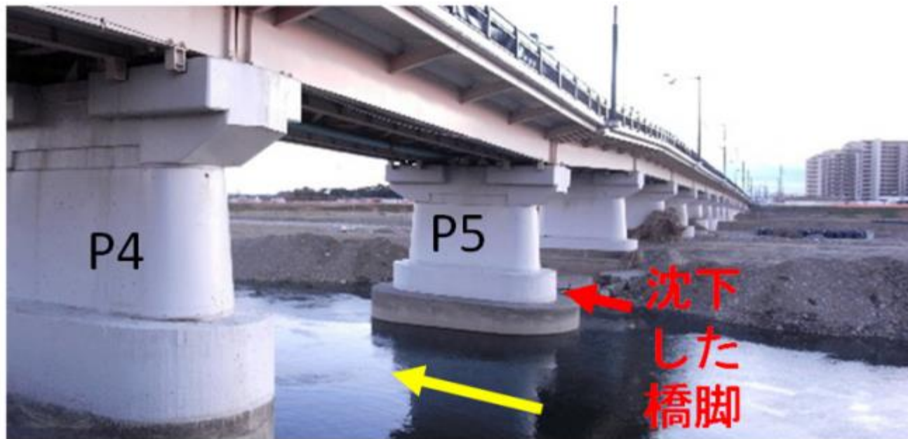
(c) 日野橋橋脚の被災状況
