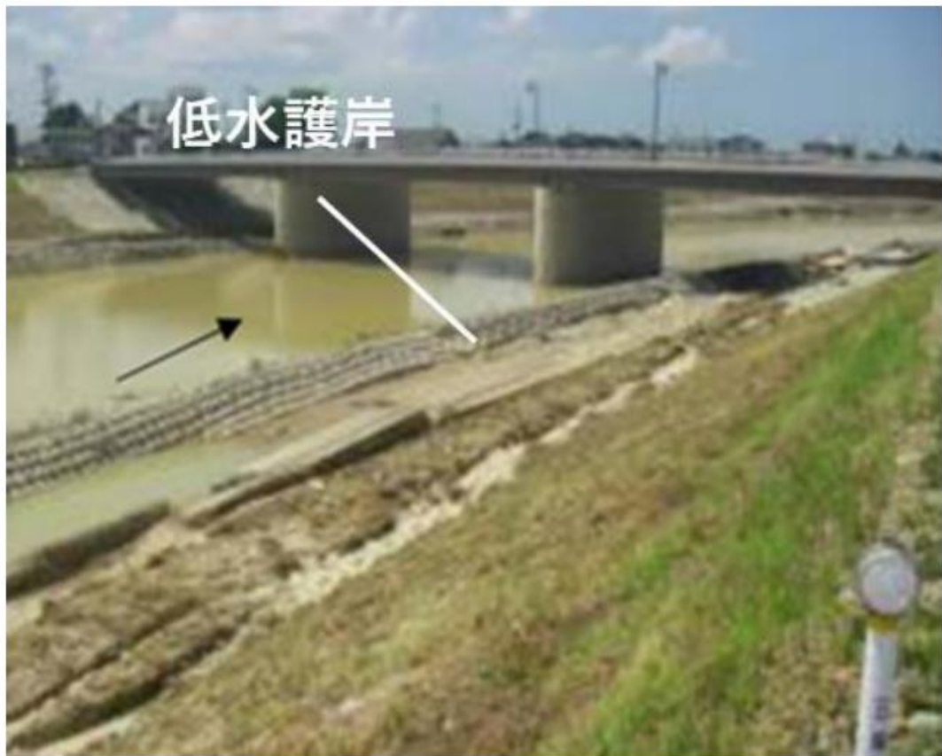
図-7a 五十嵐川における高水敷、堤防表のり面の被災比例
