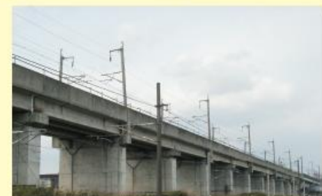
経路な損傷にとどまった東北新幹線高架橋（種馬堀）
