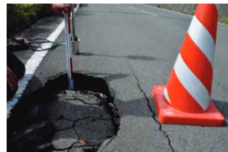
液状化による道路陥没
