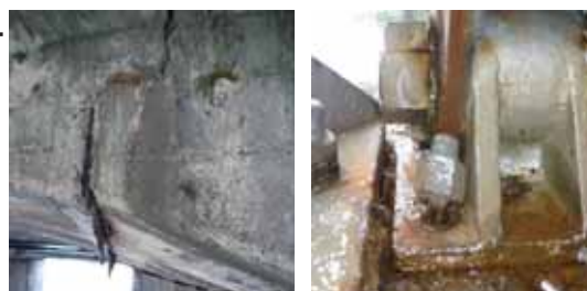
遠望目視点検で発見されなかった損傷の一例
