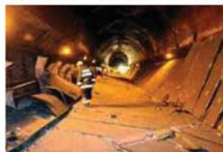
笹子トンネル事故(2012年12月)
