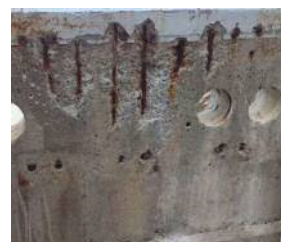
中性化・鉄筋腐食 壁高欄
