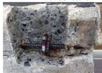
ASR鉄筋破断
