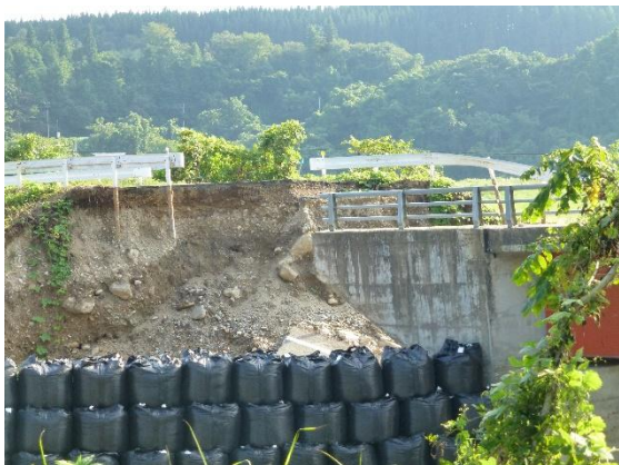
写真-2-14 落橋して寸断された道路
