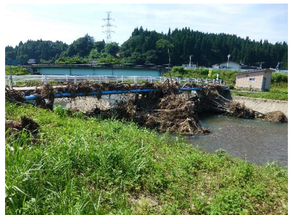
写真-2-13 河岸洗堀の様子
