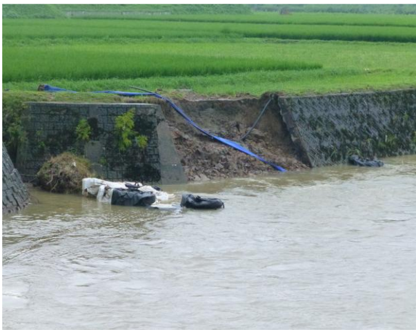
写真-3-5 護岸の被災
