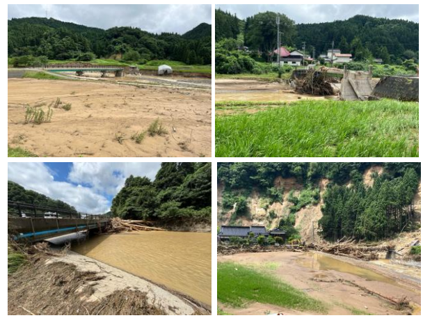
写真3 荒瀬川中上流域の橋に集積した流木群。
