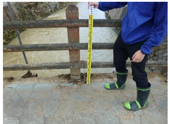
写真—1-3(2) 湯ノ又川橋の被害
