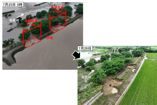
写真5 連続した堤防決壊の痕跡状況 3)
