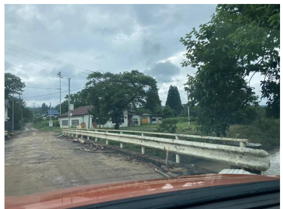
写真-2-11 上岩川周辺の被害
