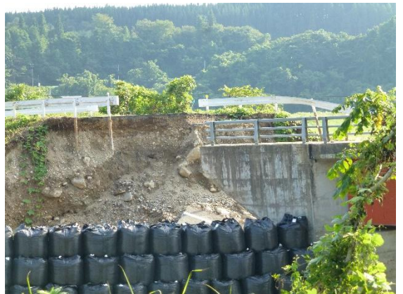
写真-2-14 落橋して寸断された道路
