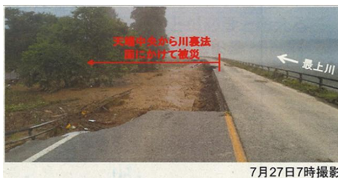
写真 2 蔵岡地区兼用堤防損壊部. (東北地方整備局)
