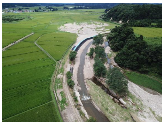
写真 1 新田川破堤第二地点からの流出.
