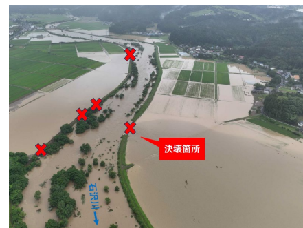
写真3 堤防決壊位置(石沢川約3～4km地点) 2)
