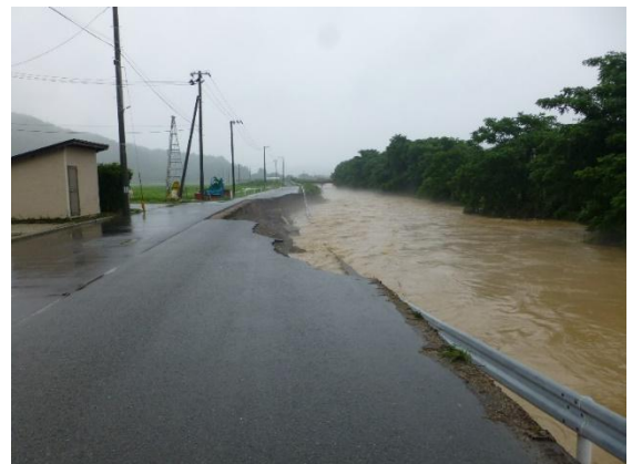
写真-2-6 左岸の洗堀の状況
