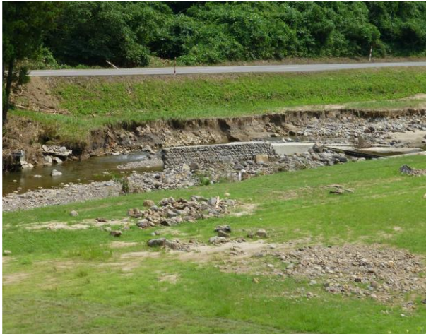
写真-3-9 護岸及び河岸の洗堀
