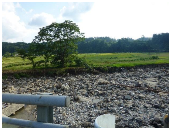
写真-2-13 河岸洗堀の様子
