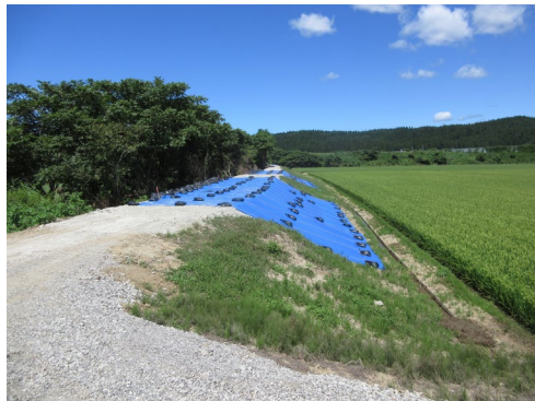
写真7 堤防決壊箇所と水田
