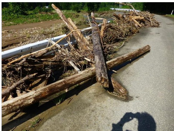
写真—1-6 ガードレールにせき止められた流木
