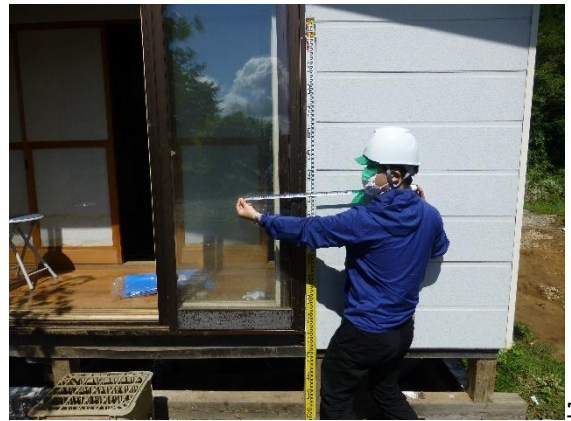
写真—1-3(1) 民家への浸水被害
