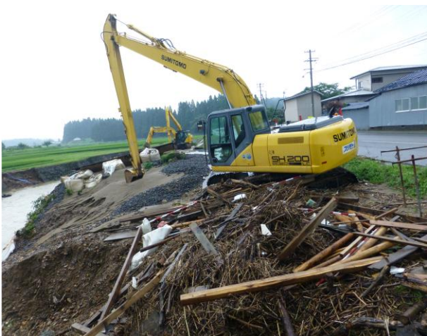
写真-3-6 工事中の被害
