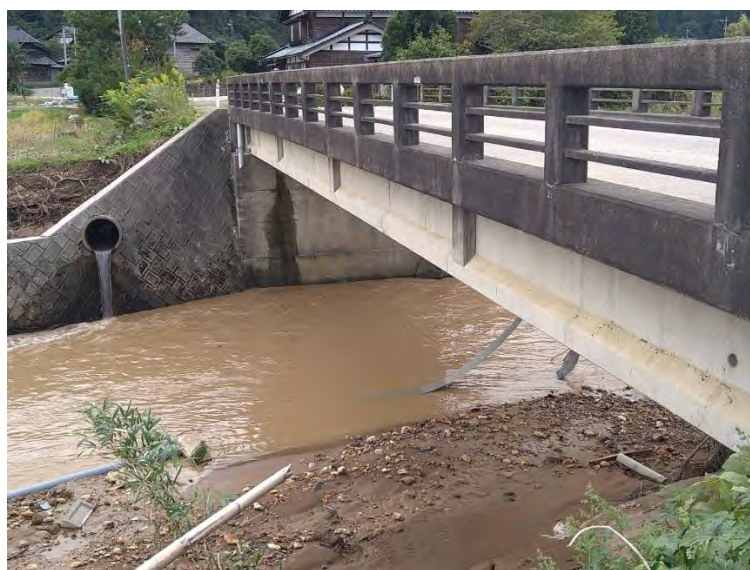
図 10-10 測定地点近傍の橋脚に残る痕跡（左岸側より撮影）
