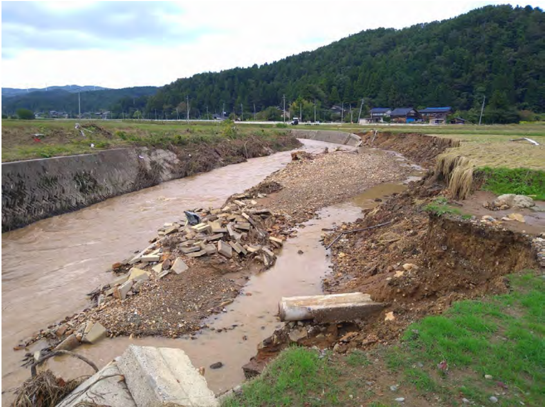
図 10-11 橋脚下流での侵食の状況
