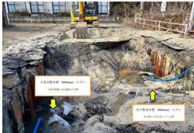
図 6-2 七尾市内の水道管の被災状況 (七尾市 HP 6) より引用)
