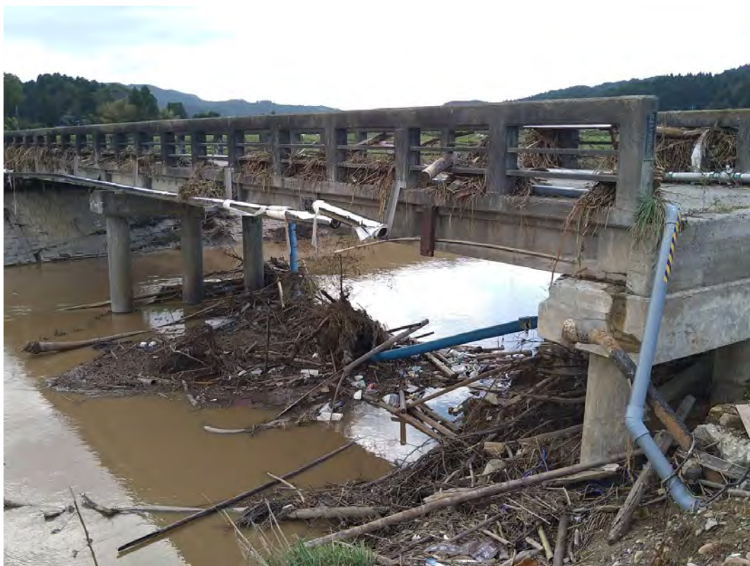
図 10-13 測定地点近傍の橋脚に残る痕跡（左岸側より撮影）
