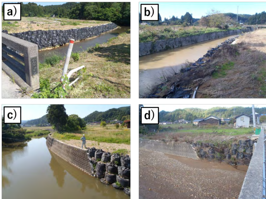
図2-18 令和6年9月21日に発生した能登半島豪雨前後における若山川の河川構造物の比較。a), c) 6月6日の調査結果, b), d) 11月8日の調査結果（写真はいずれも谷口撮影）。
