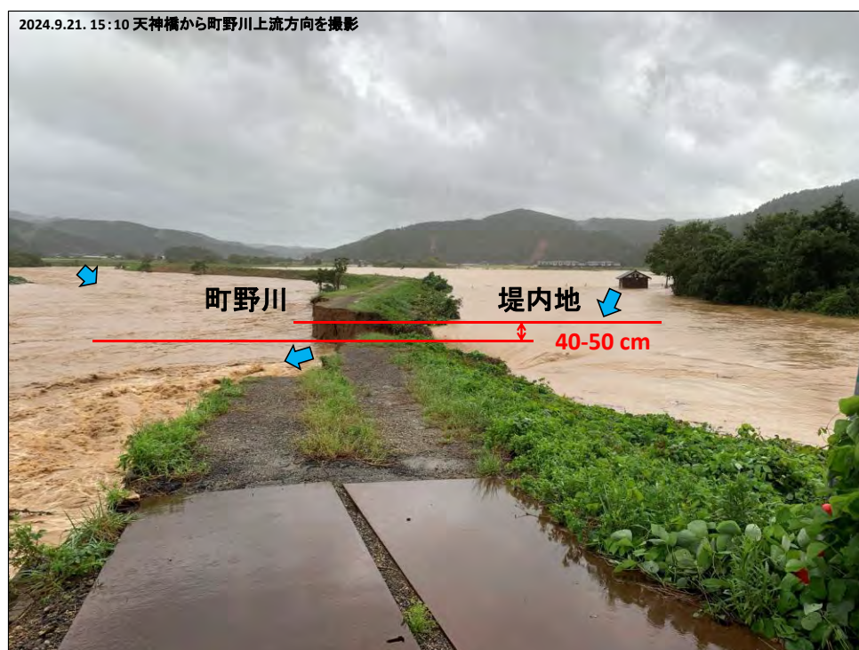
図 12-10 逆破堤直後の町野川と左岸堤内地（付近住民からの提供画像に佐藤加筆）
