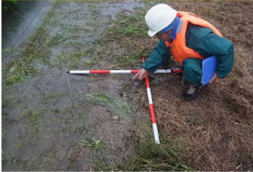
左岸4k900付近 堤内地の漏水跡
