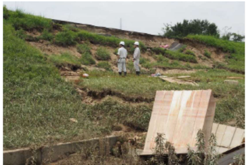
左岸4k200付近 裏法崩れ
