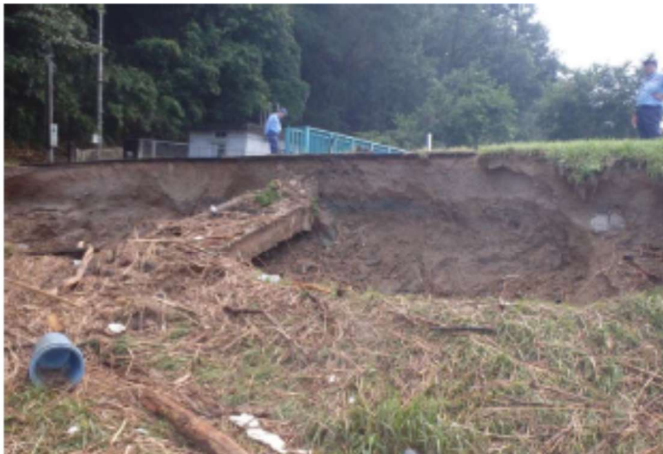
右岸4k200付近 裏法崩れ
