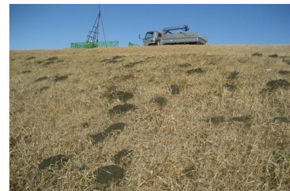
川裏側小段下法面に見られるモグラ穴の密集地帯 (ボーリング櫓は58k+110地点)
