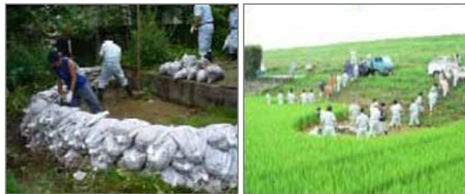
埼玉県加須市漏水状況 (旧北川辺町) (H18)
