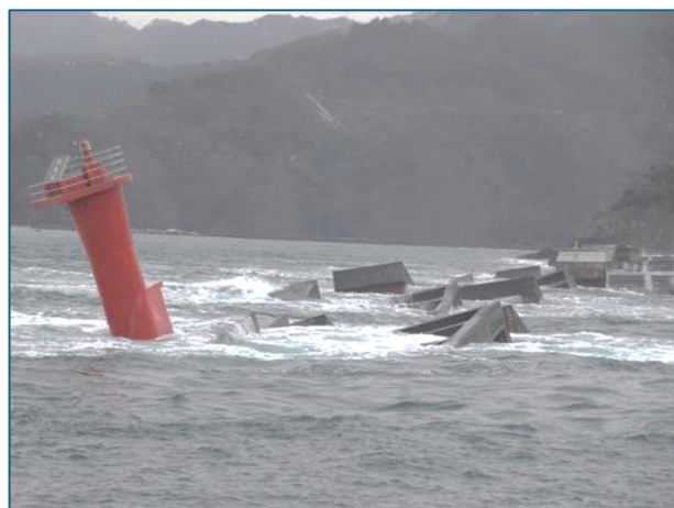
(北堤の被災状況)
