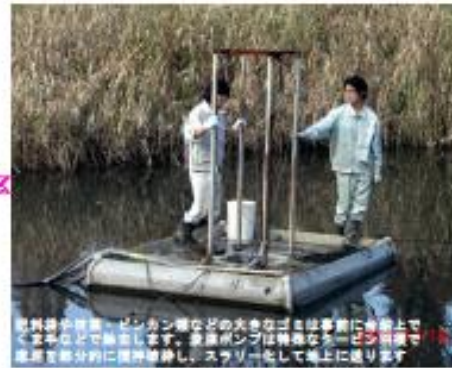
この船に特殊浚渫ポンプが搭載されており、フロート付のブレードホース・電線ケーブルで船上と接続しています
