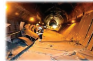
笹子トンネル天井板落下事故 (2012年12月)
