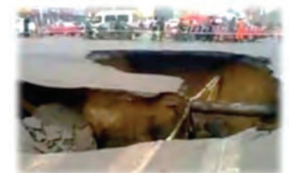
水道管の老朽化による道路陥没
