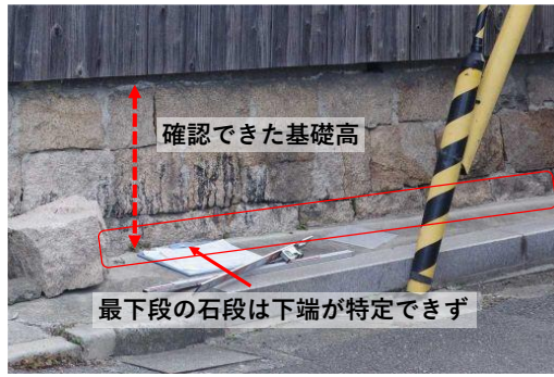
写真-2 基礎下端が特定できない段蔵の例
