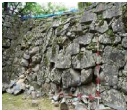
写真-1 熊本城内の変状石垣の例
