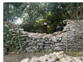
写真-11 修復対象の石垣
