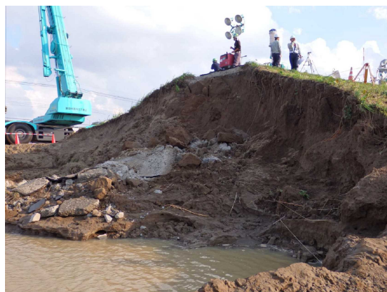
写真 破堤部分
