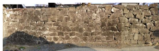
写真-3 熊本城東竹之丸東側石垣西面
