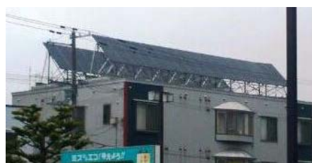
屋根面に孔をあけず設置する架台 「アートラス」にて設置（札幌市内）
