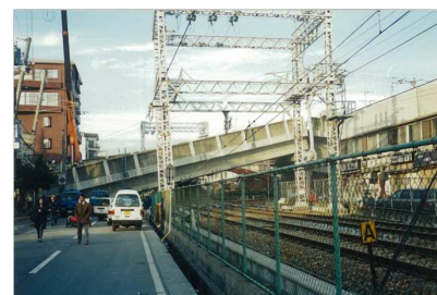
写真-2 阪神淡路大震災での新幹線 PC 橋の線路上への落下
