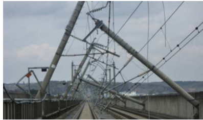
写真-3 東日本大震災での電柱の損傷
