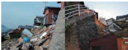
写真-1 土砂の流れ落ちた法面（左）壁とともに崩落した道路（右）
