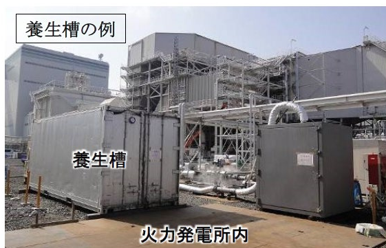
図 1.1 発電所内に設置した養生槽の例
