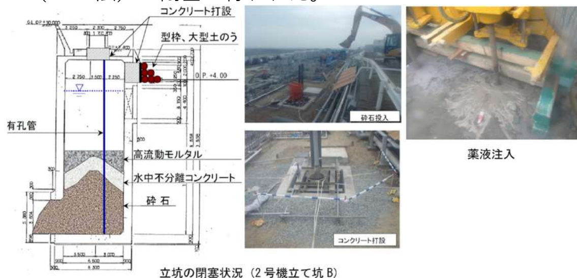
立坑の閉塞状況 (2号機立て坑B) 図 2-14 立坑・トレンチ・ピットの閉塞状況
