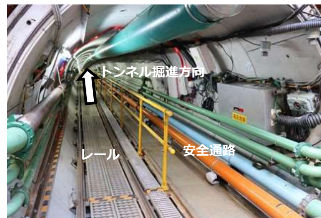
トンネル内部安全設備の整備状況
