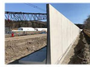
農地盛土のかさ上げに伴い、自然災害等で再生資材が流出しないように土留めの擁壁を設置します。
