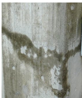
図-3.4.2 コンクリート製浮体施設損傷 漏水事例のイメージ
