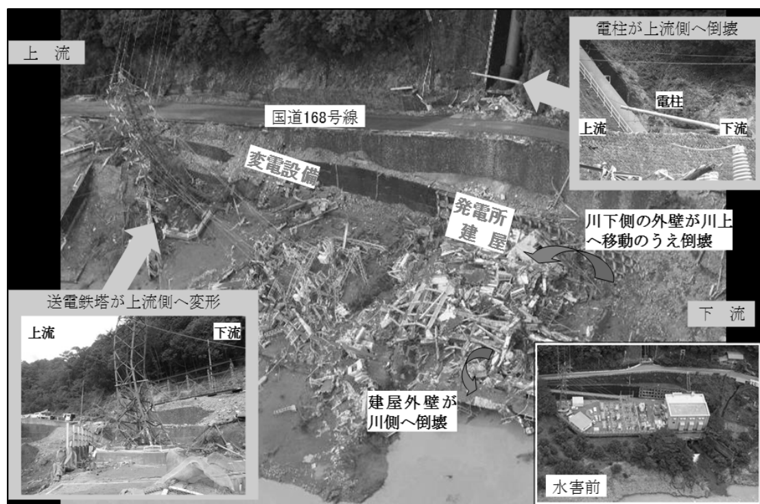
図 2.5-1 長殿発電所の被害状況.
