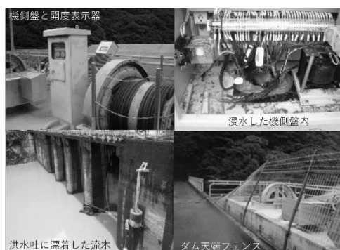
図 2.3-5 設備被害状況.
