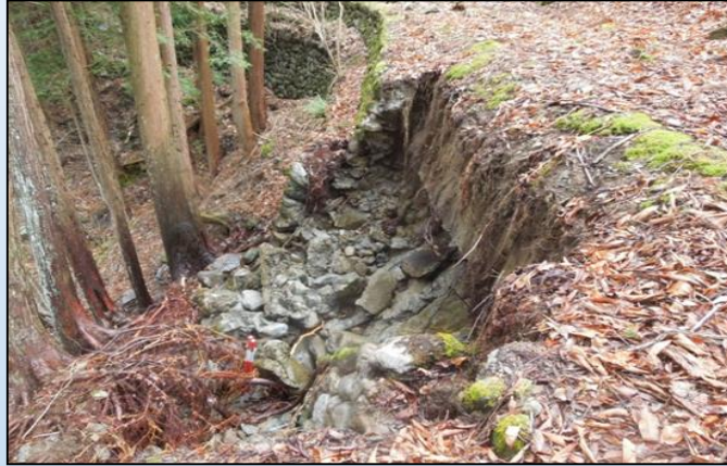
写真 6.5.3 石積み擁壁崩落状況および
