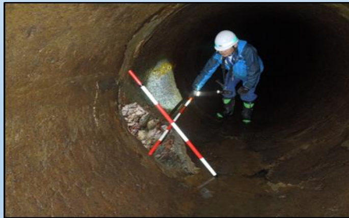
写真 6.5.1 損傷箇所（水路内部）
