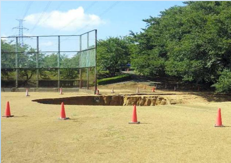
グラウンドが陥没した現場
