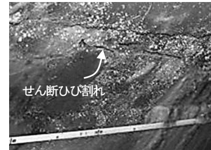
天端45°付近に発生したせん断ひび割れ
