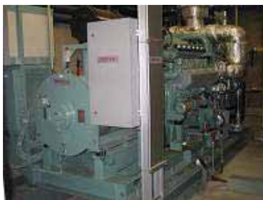
図3. 5-1 消化ガス用ガスエンジン設備
