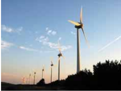
能代風力発電所（秋田県能代市） 14,400kW（600kW×24基）
