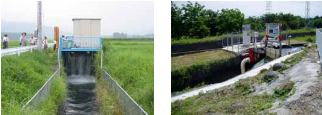
図3. 4-3 農業用水路落差工利用発電所の実証試験例
