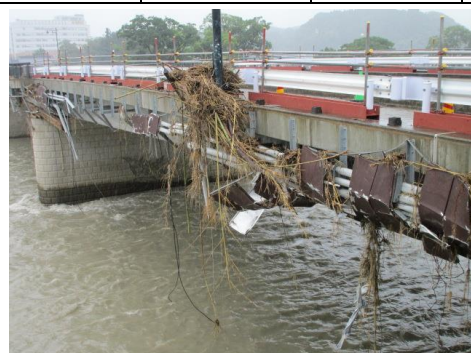
図1 橋梁添架管路の被災事例
