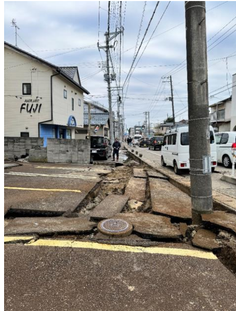
写真-5 新潟市西区における舗装の亀裂・不陸
