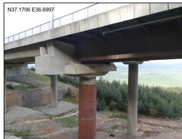
写真-1 地震で損傷し補修された橋脚 (著者撮影)
