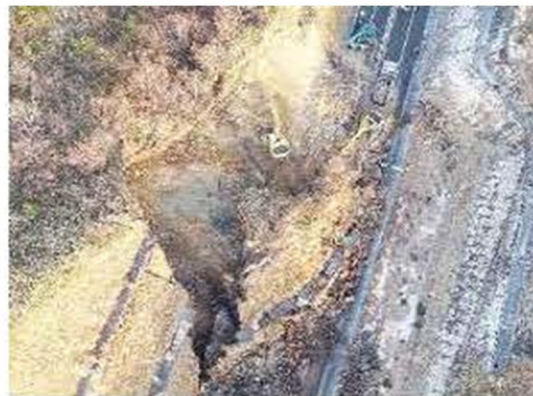
図-8 福島沖地震による道路被災状況 (NEXCO 東日本記者発表資料 (2021年2月14日) より引用)
