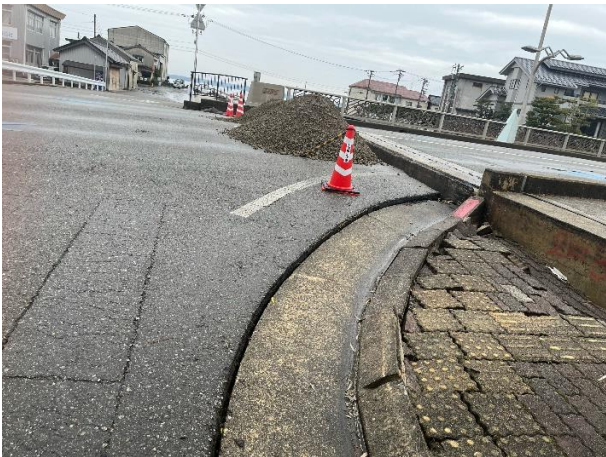
写真-4 尾湾橋におけるアプローチ部での段差
