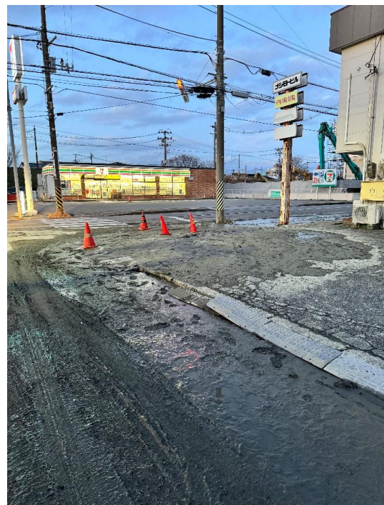
写真-6 新潟市中心区における液状化
