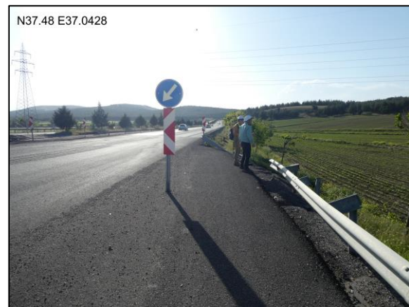
写真-2 地表地震断層の作用により約4.0mの横ずれを生じた道路(著者撮影)
