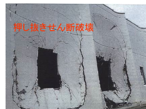
曝気槽送風機室外壁の損傷 (仙台市建設局)
