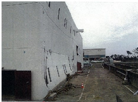
ポンプ室外壁の損傷（仙台市建設局）
