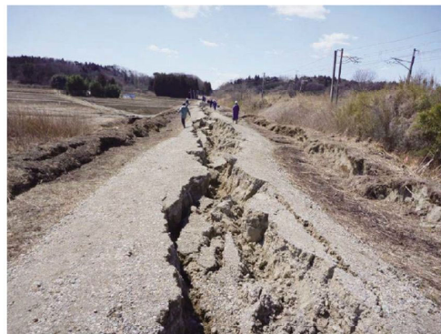
Fig. 34 パイプ敷設道路の亀裂（矢吹南第2空気弁工周辺） Cracks on the road around Yabukiminami No.2 air valve
