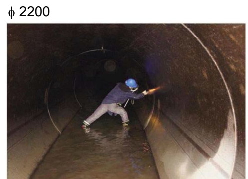
Fig. 37 不陸により滞水しているパイプ (矢吹南工区) Stagnant water due to unevenness of pipe at Yabukiminami subsection
