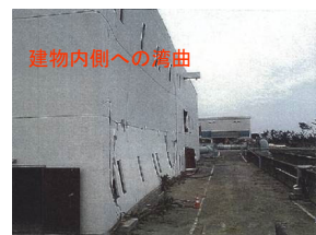
ポンプ室外壁の損傷 (仙台市建設局)
