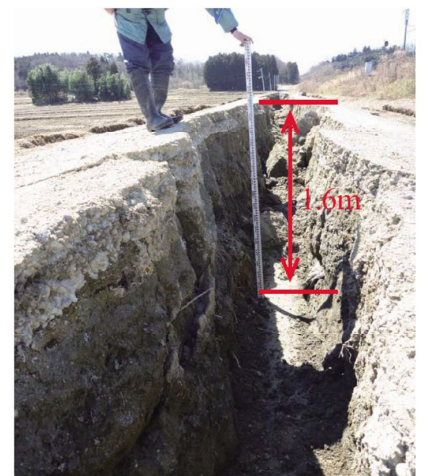
Fig. 35 パイプ敷設道路の亀裂（矢吹南第2空気弁工周辺） Cracks on the road around Yabukiminami No.2 air valve
