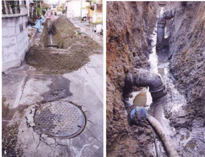
(左)人孔周囲に亀裂は入っているが、浮上はしていない。(右)取り付け間は垂直に取り付いており、埋め戻しは発生土(?)なのか、液状化の痕跡は見られない。
