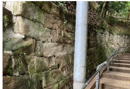
(b) 変状後の修復の様子
