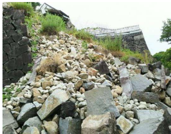
熊本城石垣崩壊現場
