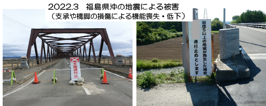
(1) 支承の損傷による通行止め措置 (2) 橋脚の補修レベルに応じた交通機能の制約措置
