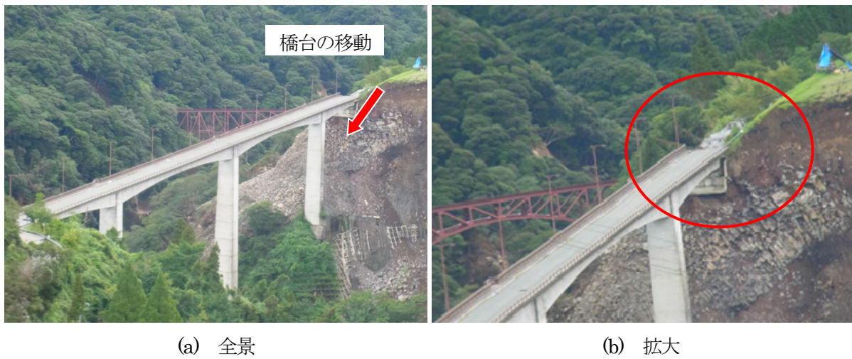
図-2.2.7 阿蘇長陽大橋の被害
