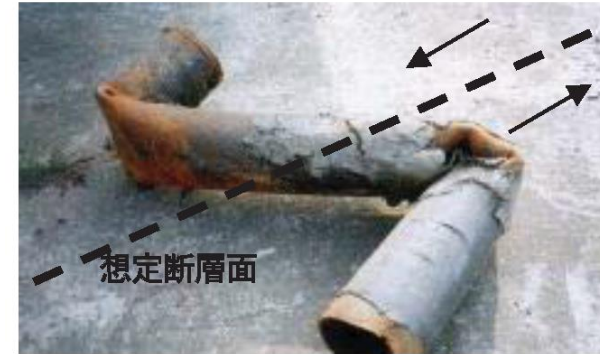
図 1-5-6 断層による管路被害（台湾集集地震 25) ）
