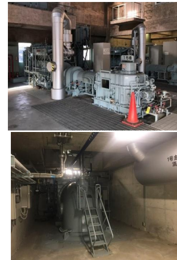
関東 蓮花川排水機場
