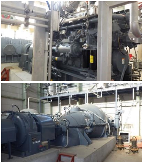
北海道 月寒排水機場
