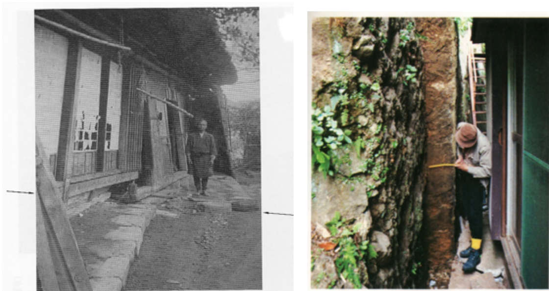
図 3.1-2 1943 年鳥取地震で出現した鹿野断層による家屋基礎のずれ(左 兵頭氏撮影 2) )と 1974 年伊豆半島東方沖地震による地表地震断層(右 3) )
