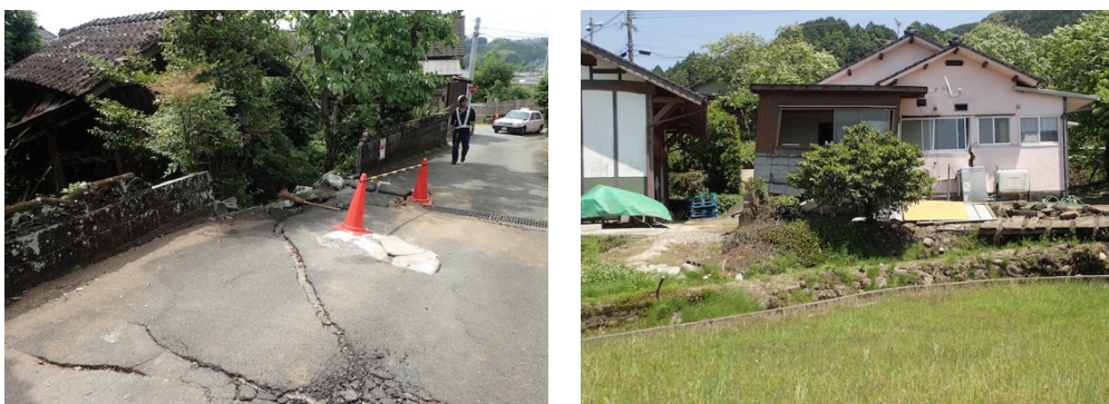
図 3.2-2 2016 年熊本地震本震による地表地震断層による被害（いずれも益城町下陳）
