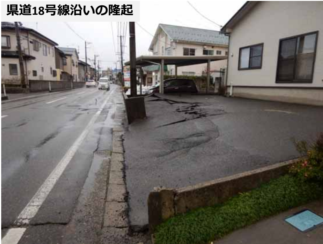
県道18号線沿いの隆起や住宅の変状
