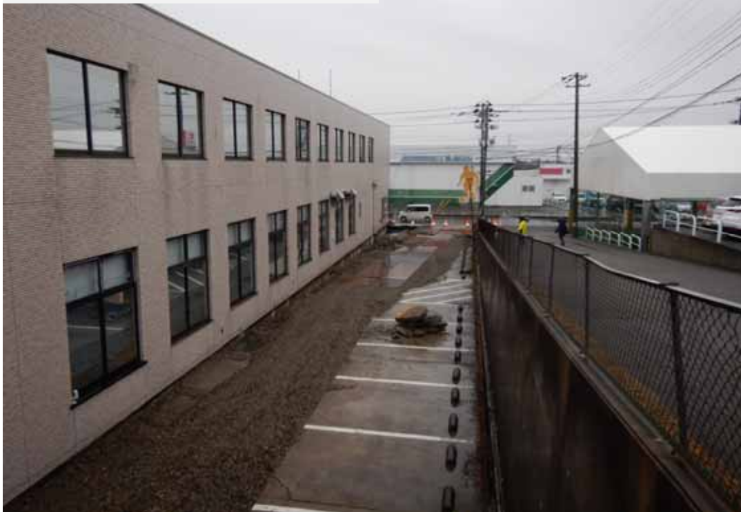
西区郵便局の外構部の沈下
