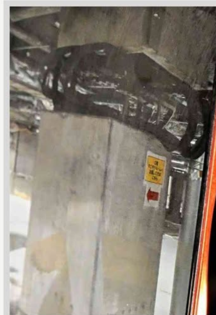
八代市の小野泰輔市長が報道陣に示した、市役所本庁舎地下のダンパーのずれ（29日、八代市）
