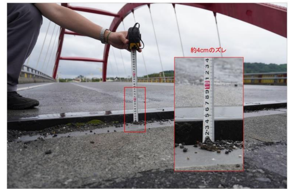
橋桁境界の段差
