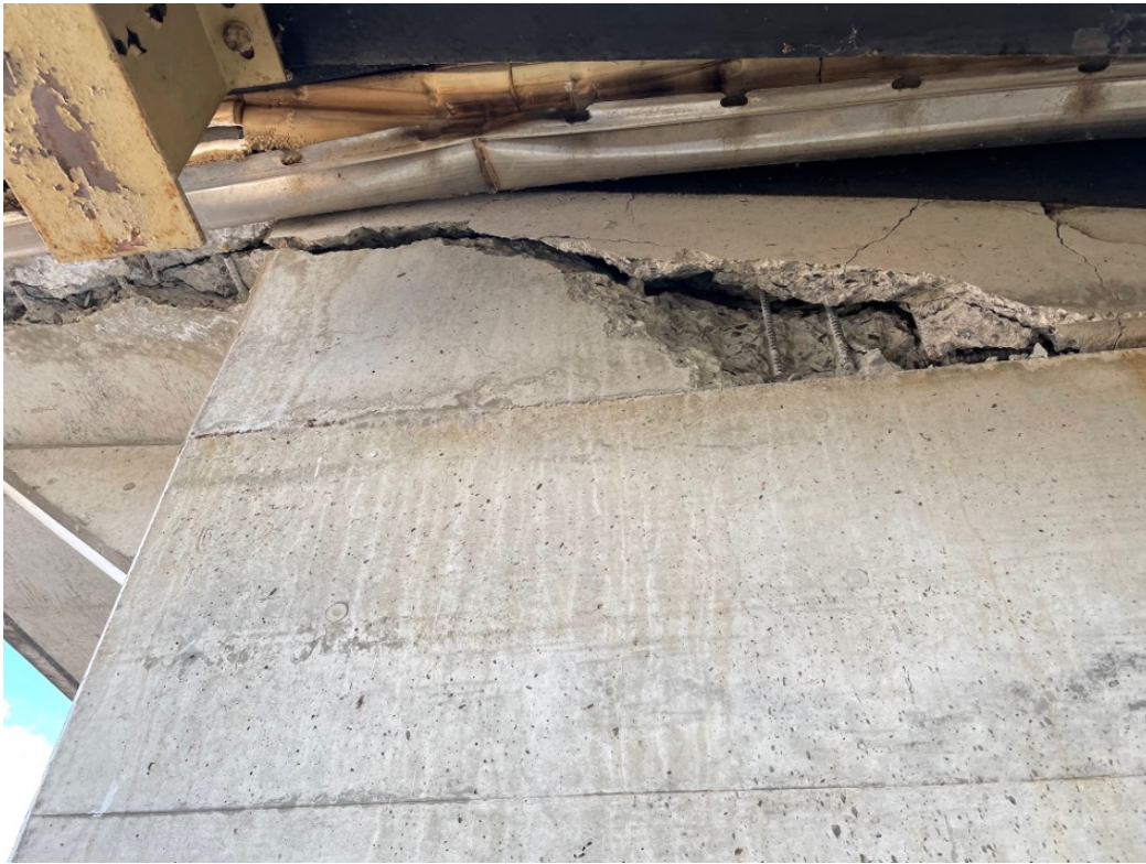
北側橋台パラペットの損傷、 鉄筋露出、伸縮装置の損傷
