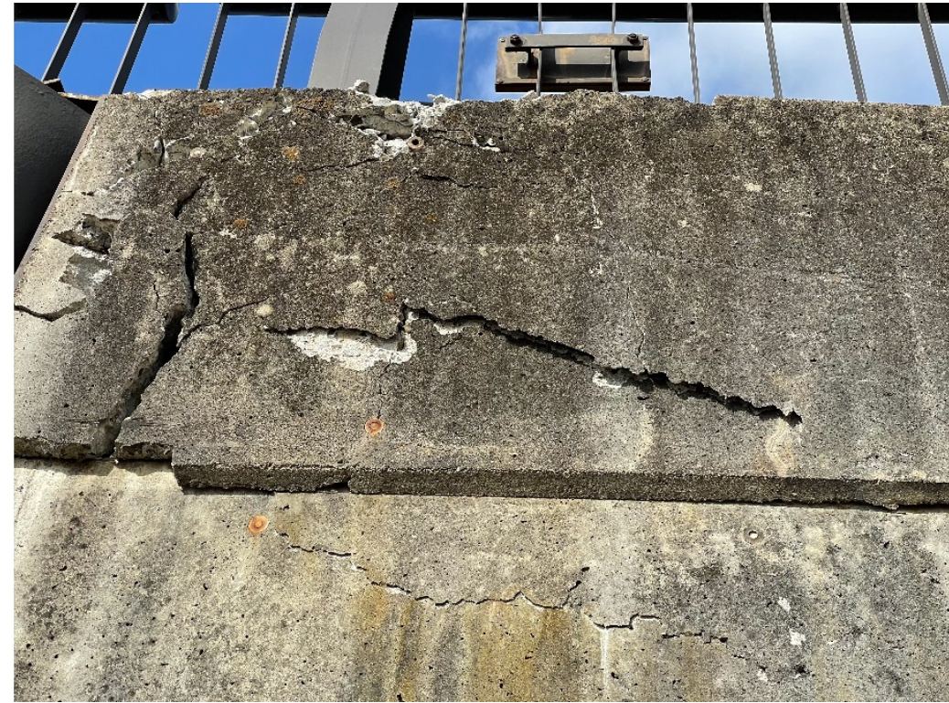
南側橋台の損傷
