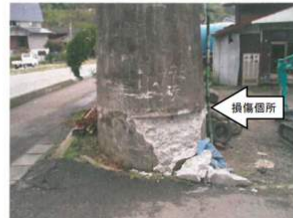
写真6 貫通ひび割れおよび打継目下部コンクリートの剥落(17P) [27]
