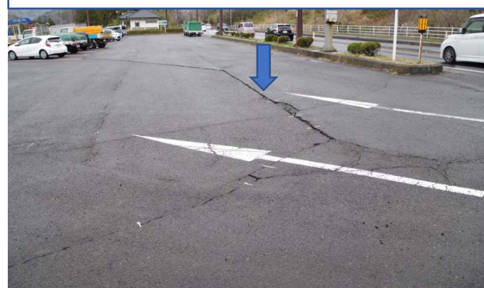
国道4号の被害：路面にクラック、変状確認。
