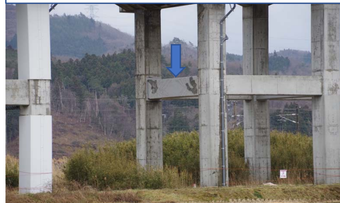
高架橋の下部構造：水平梁に損傷確認される。
