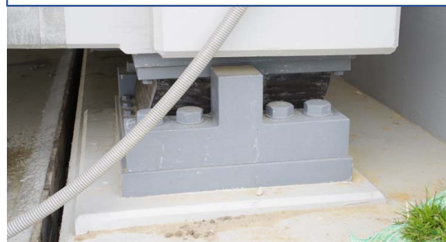
左岸側橋台の支承：相対変位を確認。但し地震の影響が不明。要調査が必要。
