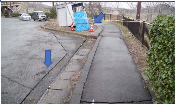
国道4号の被害：路面クラック等の変状，電話ボックス及び倉庫の沈下傾斜
