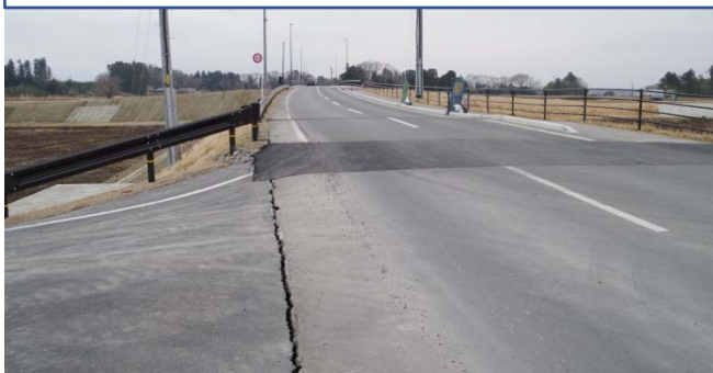
アプローチ部：カルバート周辺の変状やクラックが確認される。
