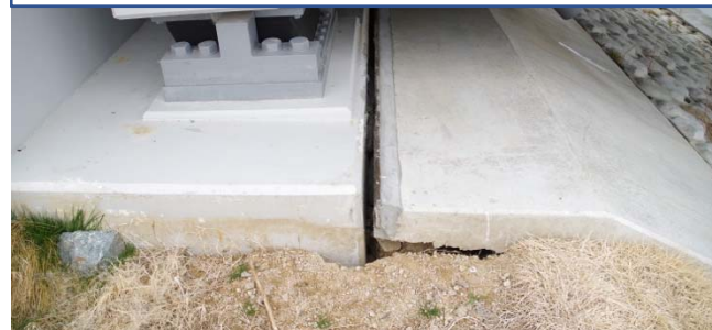
橋台全面の護岸：沈下と移動と思われるクラックが確認されたが、この地震によるものか要調査が必要。
