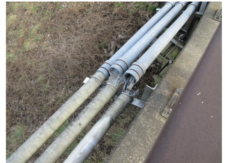
通信添架管の継手抜け
