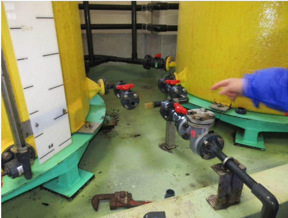
塩素の室内配管で抜け。1/7対応済み
