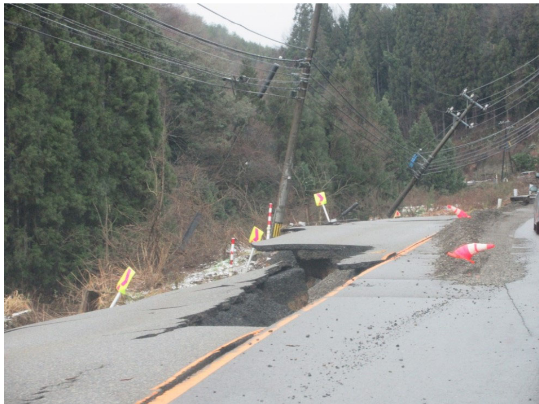
道路盛土の崩壊。
