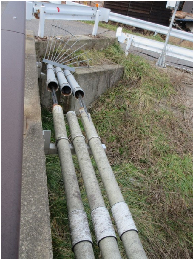
通信添架管の継手抜け
