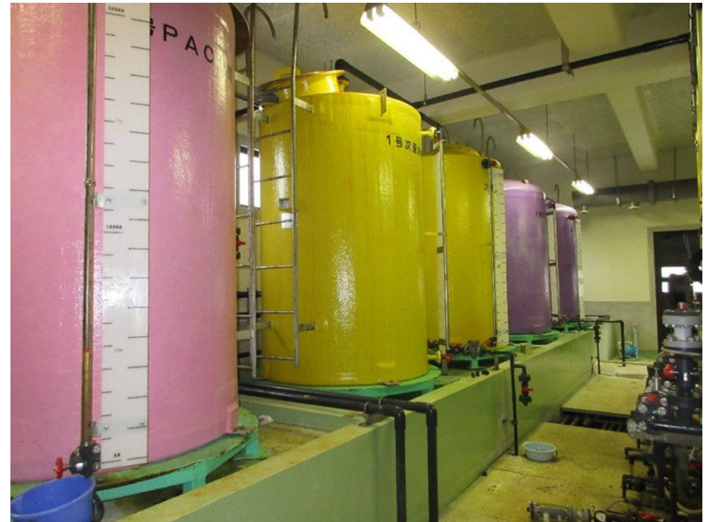
1月中旬にPACの薬品が入ってくる予定だが、10tトラックが浄水場まで入ってこれるか不安とのこと。
