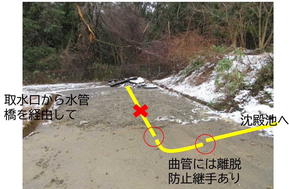
導水管DIP(A)250：場内の沈殿池前で漏水。エルボ管には離脱防止継手が付いていたが、その隣接の直管のA形継手で抜け。継輪で復旧。
