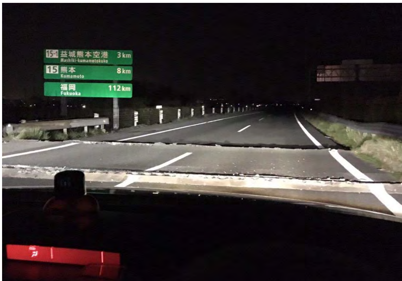
高速道路の横断ボックスカルバートの前後の盛土が変形沈下してできた段差
