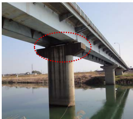
支承部の近接点検がしにくい
