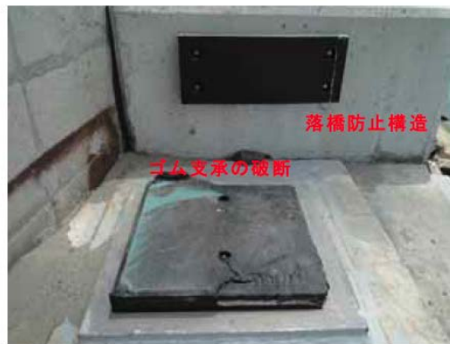
写真-3.4.22.12 A2 橋台下流側支承の損傷状況
