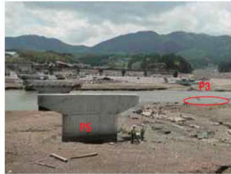
写真-3.4.23.5 P3橋脚の流出した位置
