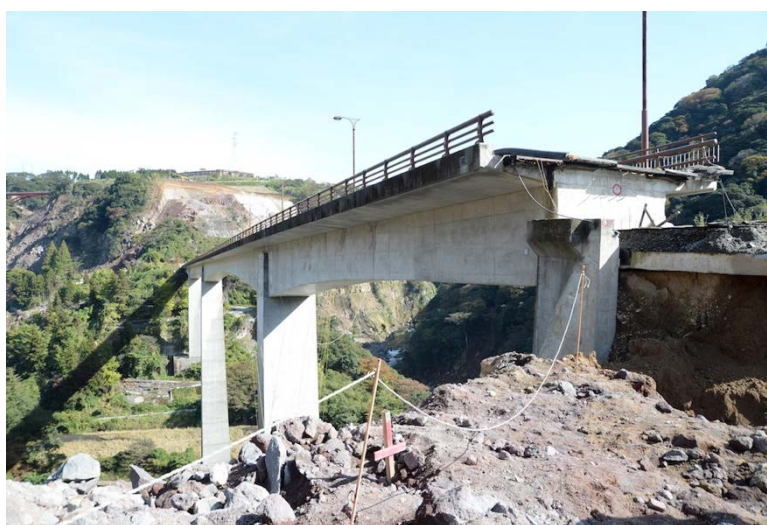
図2 阿蘇長陽大橋の橋台部被害と片持ち梁となった桁
