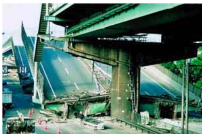
シナリオC：桁が橋軸方向へ変位した例
