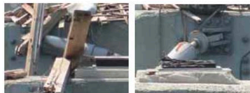
写真-3.4.22.32 P1 橋脚のダンパー (左：下流側、右：上流側)
