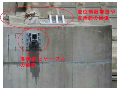
写真-3.21.4.14 P1 橋脚の損傷状況 (P2 橋脚側より)
