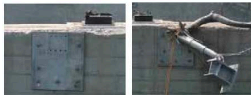
写真-3.4.22.30 P3 橋脚のダンパー (左：下流側、右：上流側)
