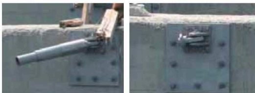
写真-3.4.22.31 P2 橋脚のダンパー (左：下流側、右：上流側)
