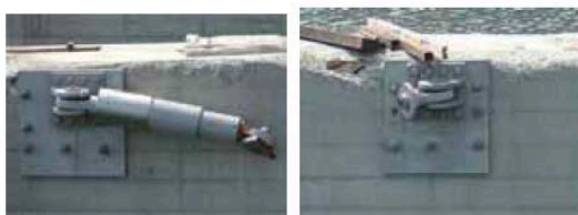
写真-3.4.22.29 P4 橋脚のダンパー (左：下流側、右：上流側)
