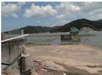
写真-3.21.4.2 新北上大橋(A1橋台上流側より上部構造の流出を確認)
