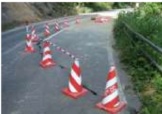
写真-1.1.48 白崖地区での被害 22)
