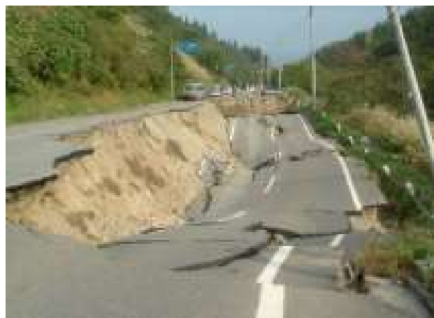
写真-1.1.15 上野地区での崩壊 15)
