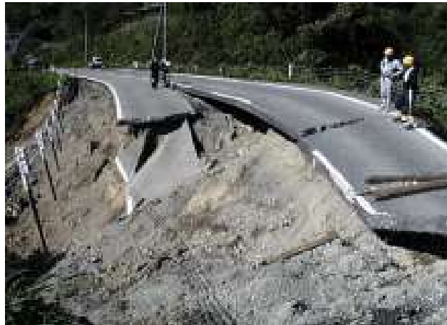
写真-1.1.17 中仙田地区での崩壊 15)
