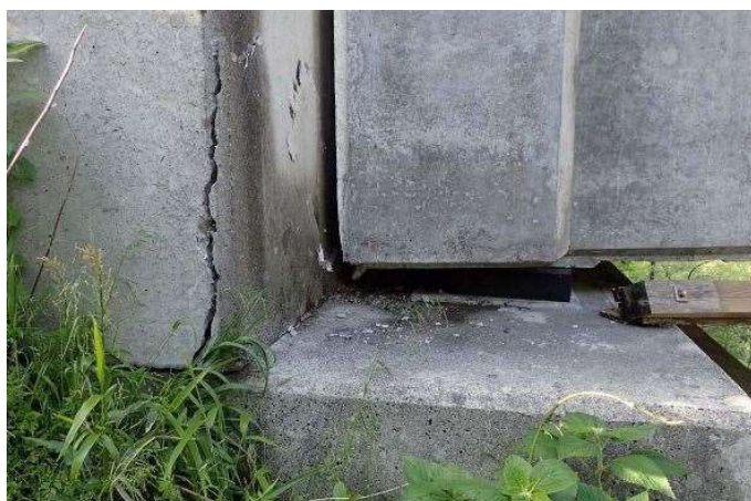
写真-1.2.61 橋台のひび割れ・剥離（すすきの原橋） 34)
