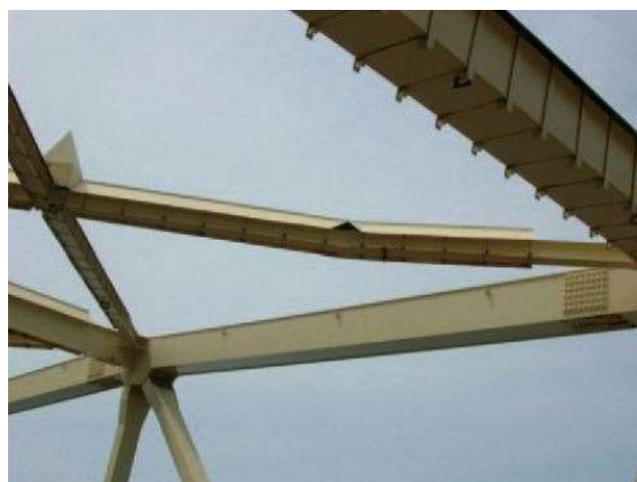
写真-1.2.25 上横構の座屈変形（胞姫橋） 18)
