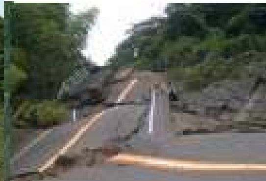
写真-1.1.46 長岡市大積千本町での被害 20)
