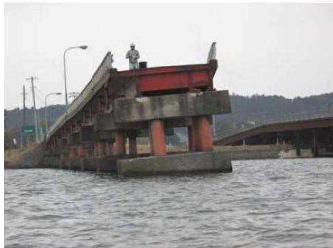
写真-1.2.43 地震後の落橋部の様子（鹿行大橋） 27)
