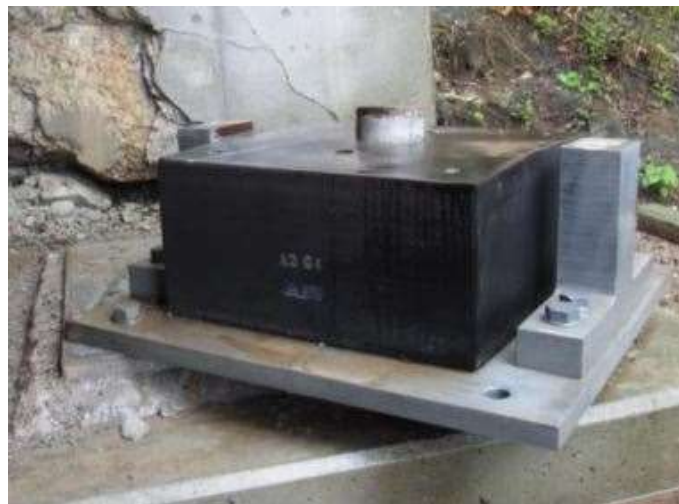
写真-1.2.60 破損したゴム支承（俵山大橋） 29)
