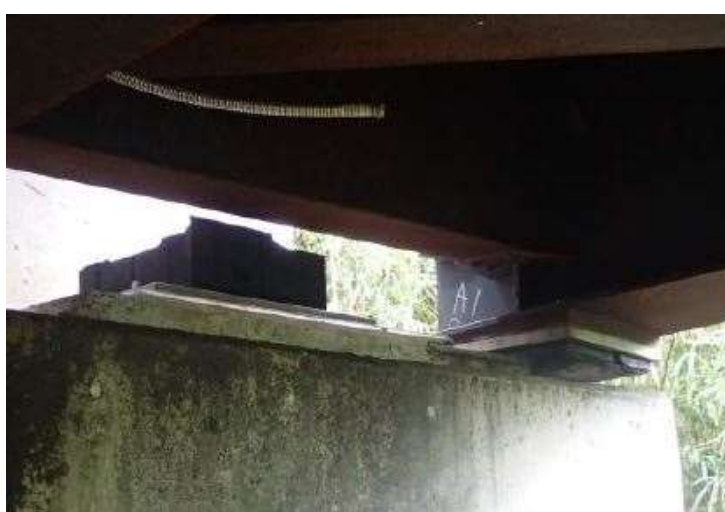
写真-1.2.64 ゴム支承の破断（大切畑大橋） 29)
