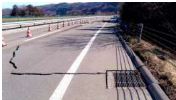
写真-1.1.58 8.9kp での被害状況 27)
