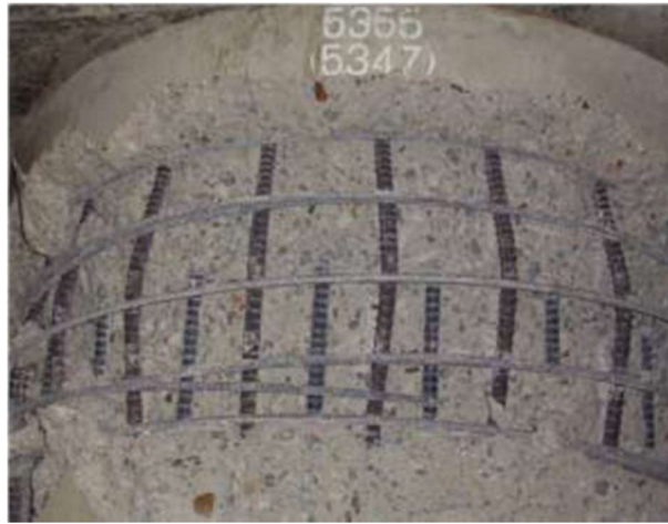
写真-1.2.1 P5 橋脚の断面損傷（新組跨線橋） 13)
