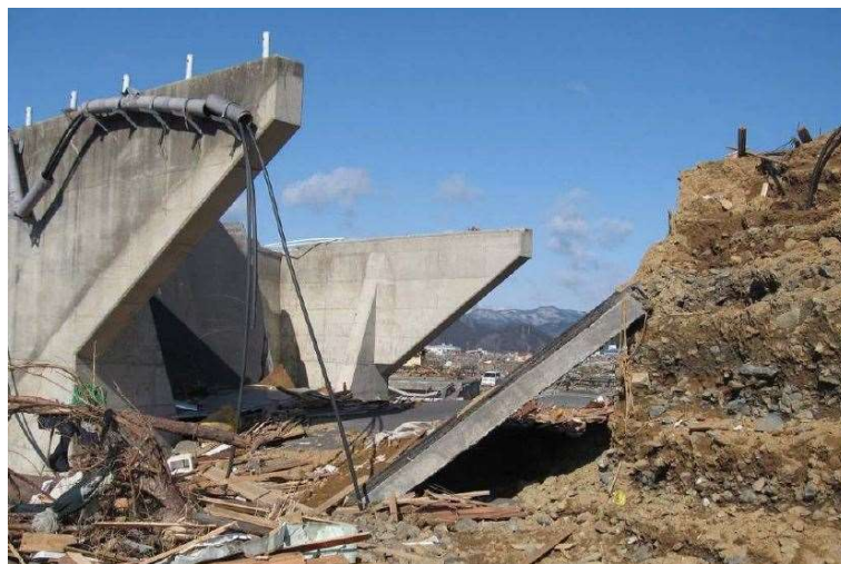
写真-1.2.38 橋台背面土の流出（沼田跨線橋） 25)
