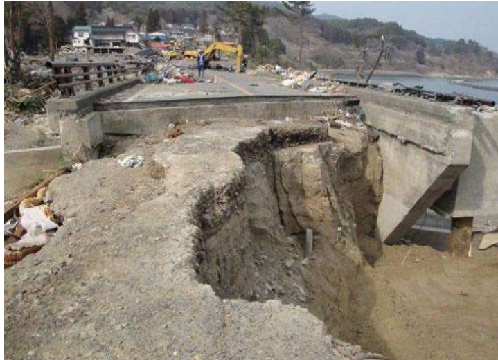
写真-1.2.40 橋台背面土の流出（浪板橋） 25)
