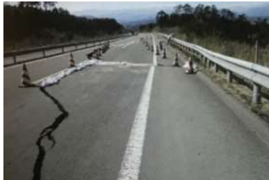
写真-1.1.57 6.6kp での被害状況 26)
