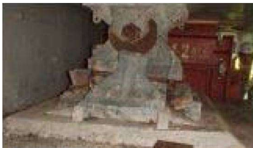
写真-1.2.20 支承の損傷（上輪新田橋） 19)
