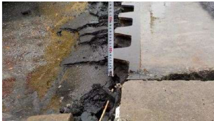
写真-1.2.66 橋面部の沈下（白川橋） 29)
