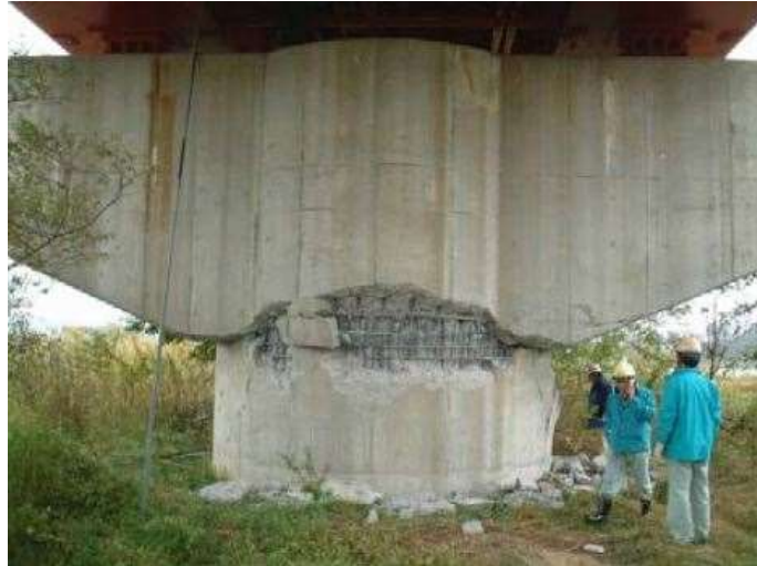
写真-1.2.6 かぶりコンクリートの剥離（小千谷大橋） 13)
