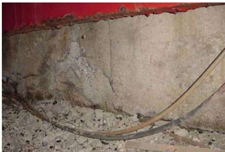
写真-1.2.9 橋台パラペットのひび割れ（和南津橋） 12)
