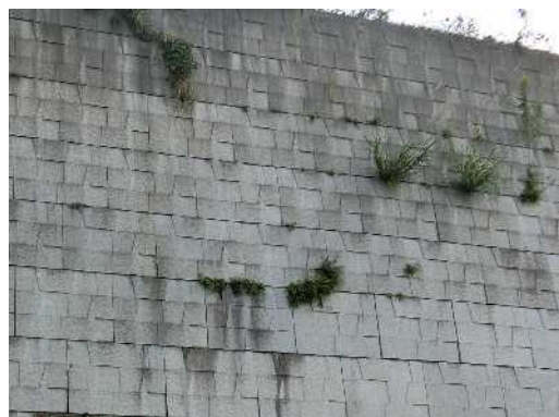
(c)壁面からの漏水
