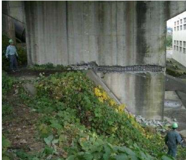
写真-1.2.12 かぶりコンクリートの剥離（山辺橋） 12)
