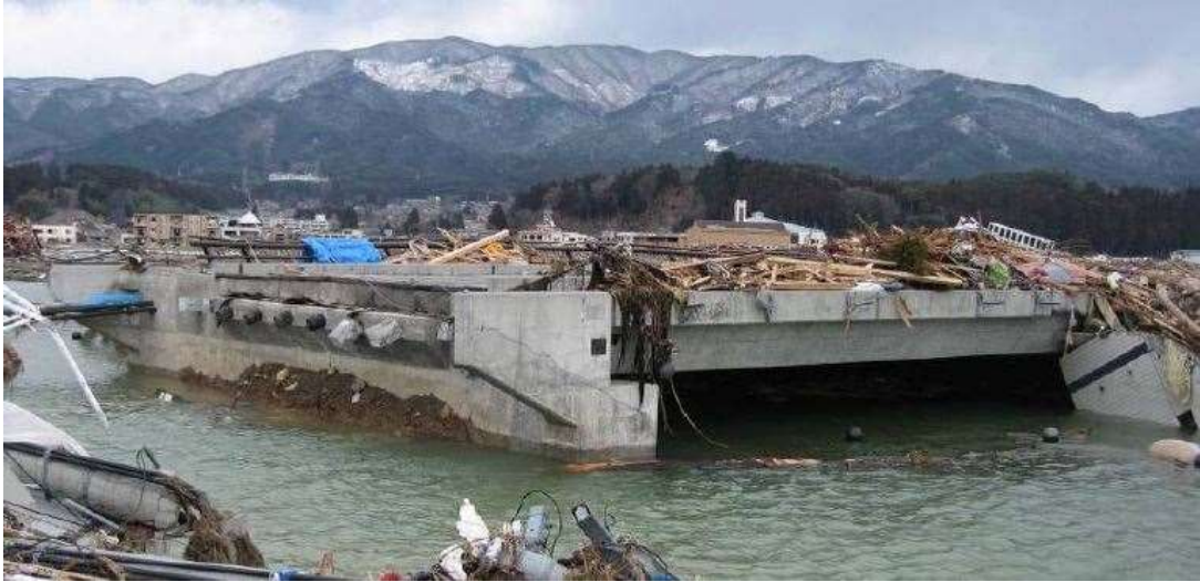
写真-1.2.39 橋台背面土の流出（川原川橋） 25)
