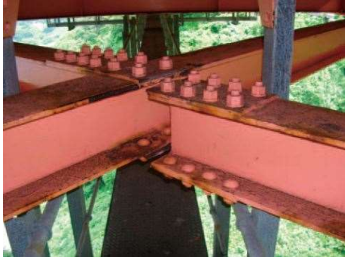
写真-1.2.26 下横構連結板の破断（胞姫橋） 18)
