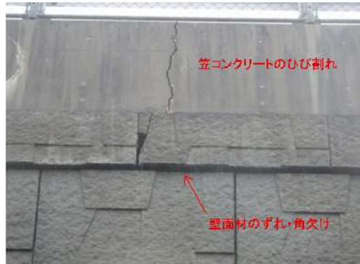
(b) 最上段の壁面材のずれ，角欠け 図-2 2016年熊本地震を受けた補強土壁
