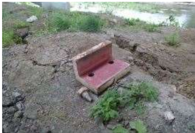
写真-1.2.53 サイドブロックの落下 (秋津川橋) 31)
