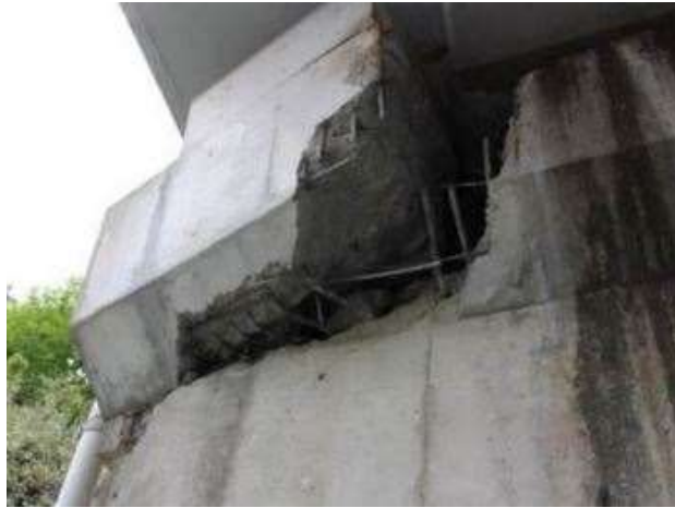
写真-1.2.51 橋台のせん断破壊 (東原橋) 29)
