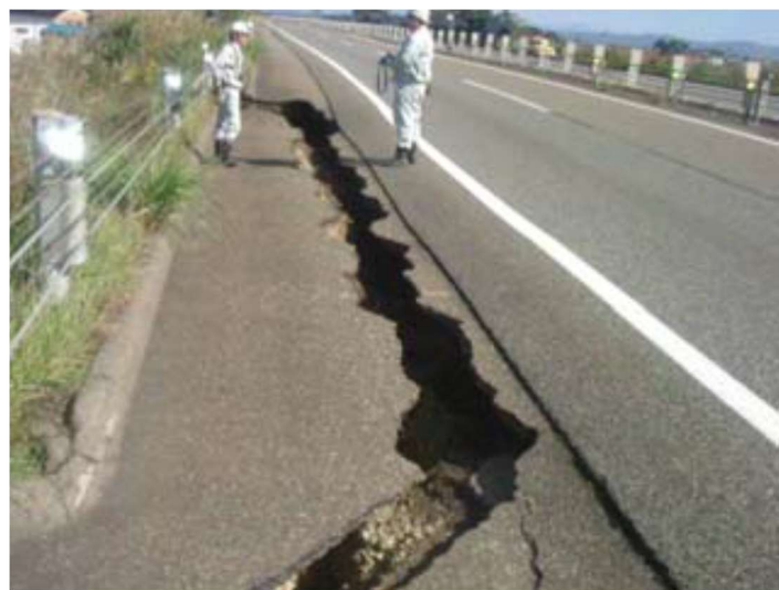
写真-1.1.8 418.8kp での陥没 1)
