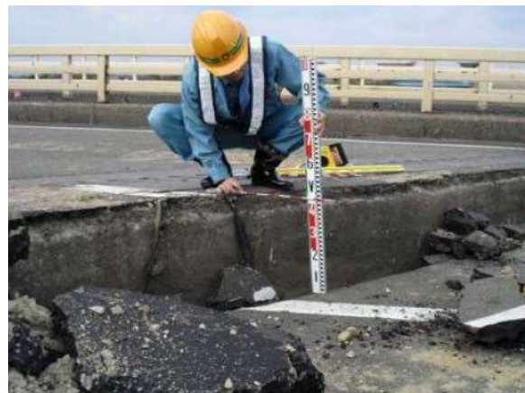
写真-1.2.3 ジョイント部の段差（見附大橋） 12)
