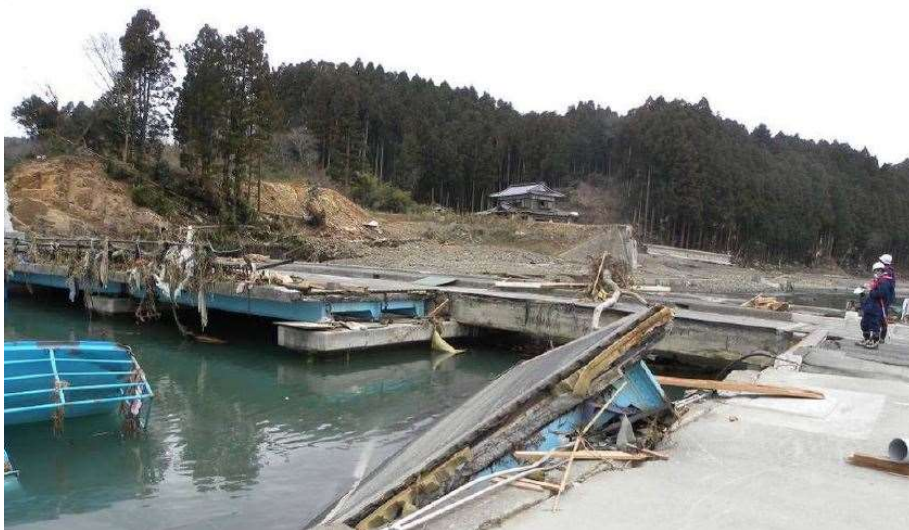
写真-1.2.41 上部工の流出（水尻橋） 25)
