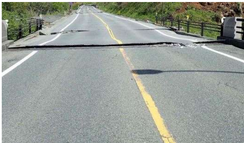
写真-1.2.62 橋面の陥没（すすきの原橋） 34)
