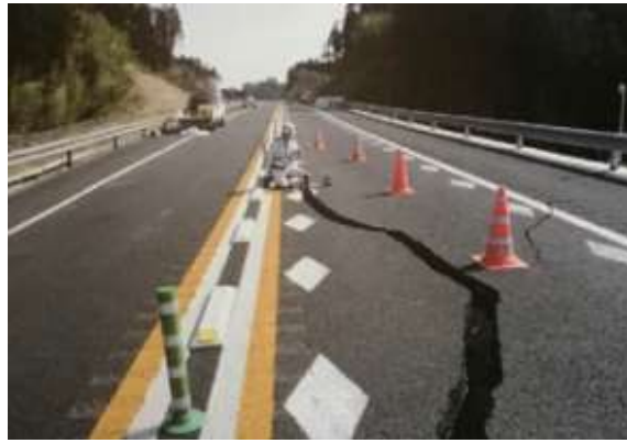
写真-1.1.56 8.9kp での被害状況 26)
