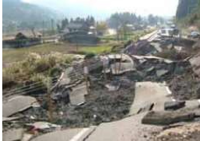
写真-1.1.14 小千谷市細島での崩壊 14)
