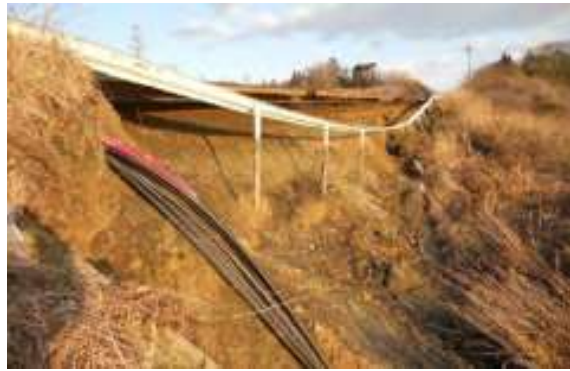
写真-1.1.68 山元町坂元付近での被害状況 29)
