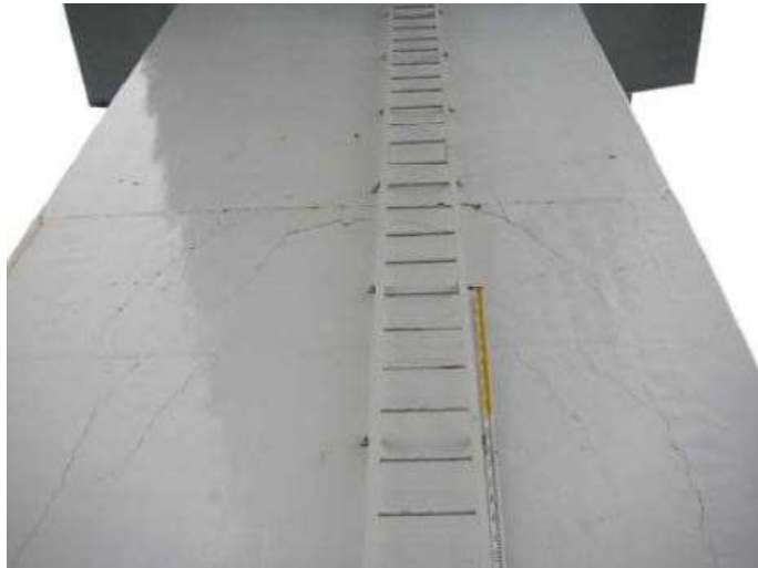
写真-1.2.16 P10 橋脚のせん断ひび割れ（能登島大橋） 16)
