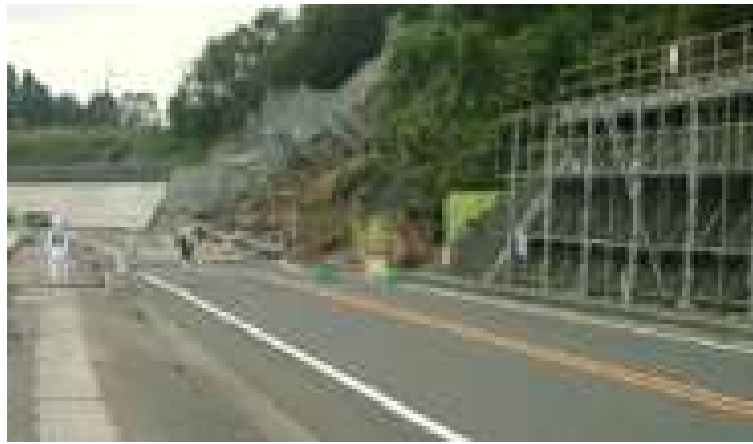
写真-1.1.11 牛ヶ島地区の被災箇所 13)
