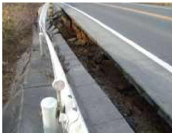
写真-1.1.70 相馬市鹿島区川子付近での被害状況 30)
