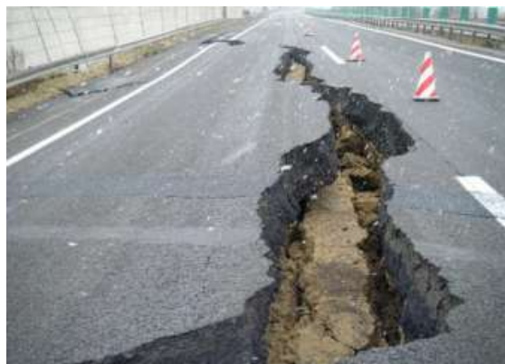
写真-1.1.62 274.6kp での被害状況 26)
