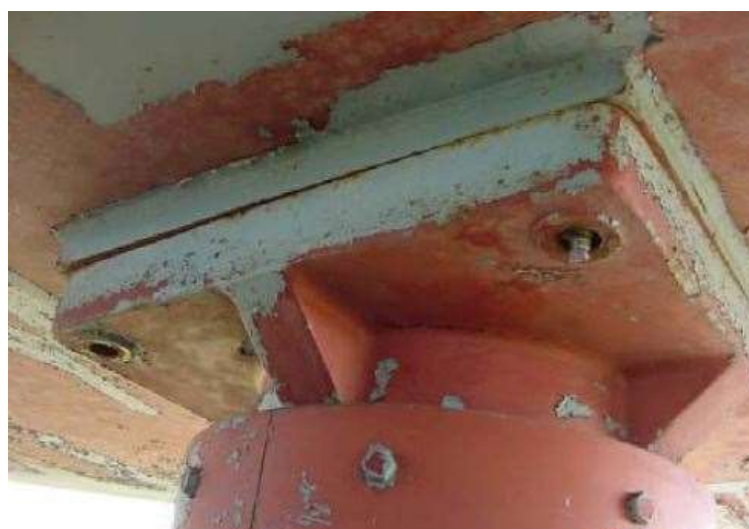
写真-1.2.11 支承セットボルトの破損（越の大橋） 14)
