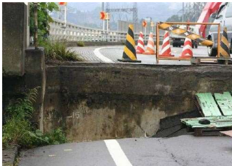
写真-1.2.13 橋面の段差被害（山辺橋） 12)
