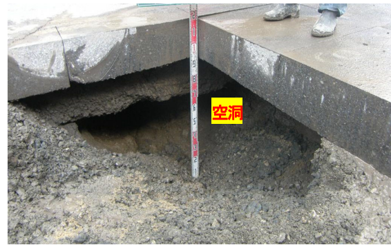
写真-2 液状化によって発生した空洞
