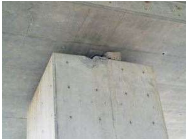
写真-1.2.14 橋脚部コンクリートの剥落（十日町橋） 15)
