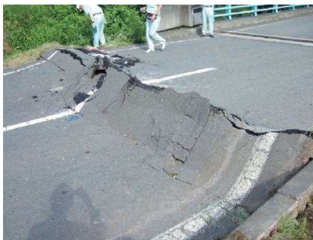
図 3.4.1-4 A2 橋台背面付近の路面損傷（餅転橋） 23)
