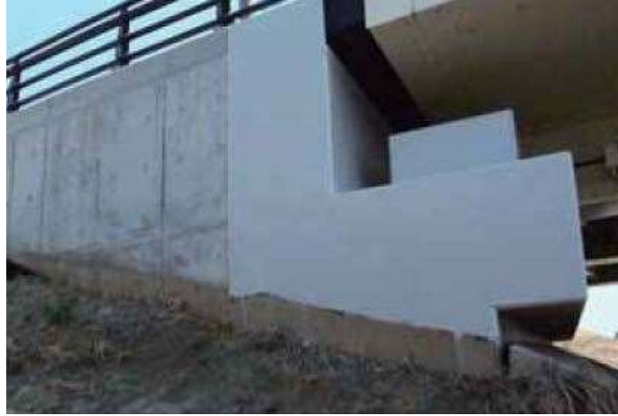
写真-1.2.50 橋台周辺土の沈下（鮫川橋） 27)
