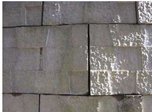
(b)漏水を伴う目地開き
