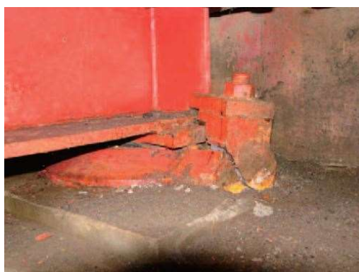
写真-1.2.31 固定支承の損傷 (丹寿橋) 21)
