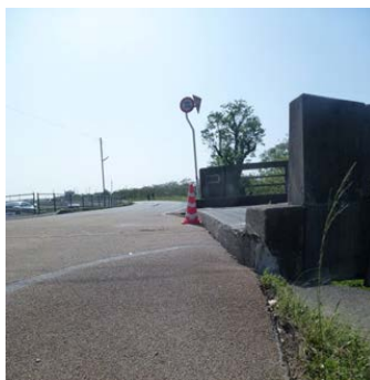
(a) 4 月 15 日午後撮影（段差量約 15cm）
