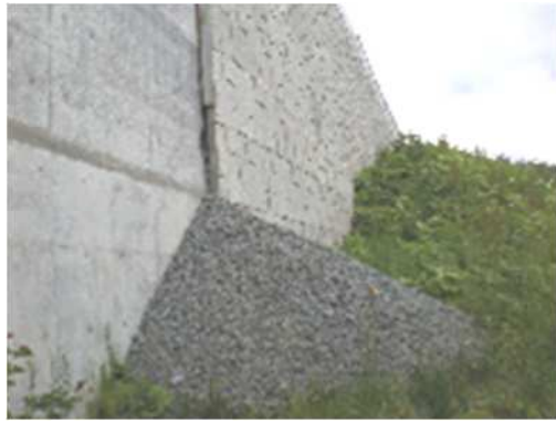
(a)排水層の碎石のこぼれ出し
