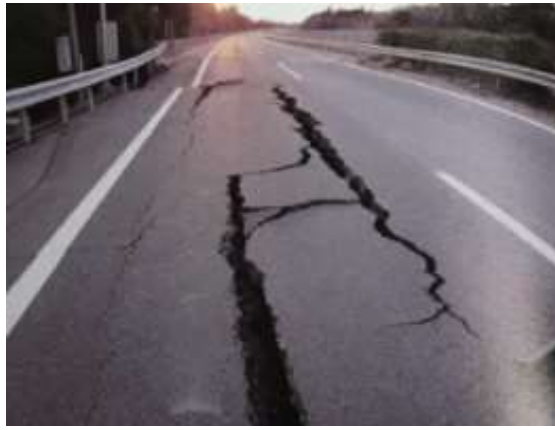
写真-1.1.66 183.9kp での被害状況 26)
