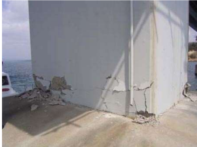
写真-1.2.15 P7 橋脚基部の損傷（能登島大橋） 16)
