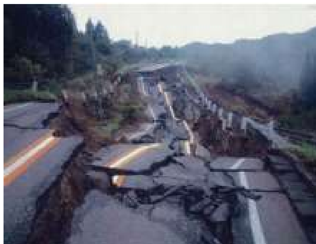
写真-1.1.18 長岡市宮内町での崩壊 16)
