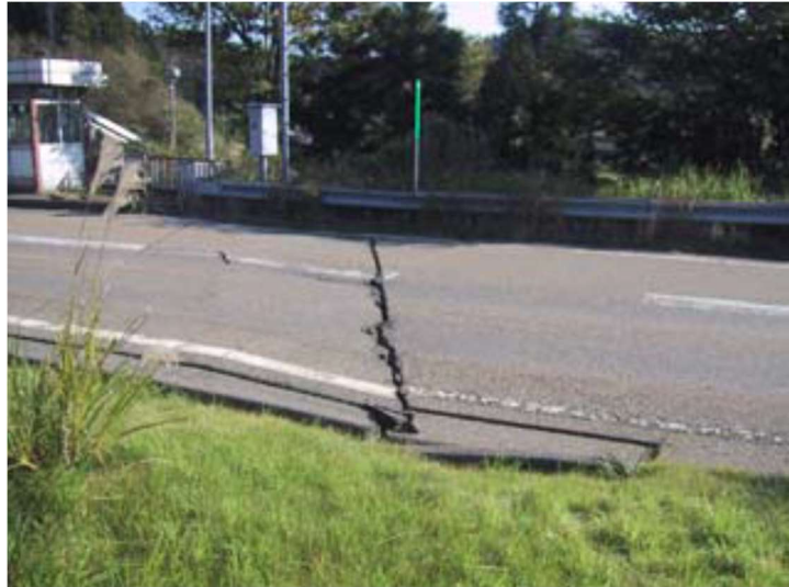
写真-1.1.6 415kp での亀裂 1)
