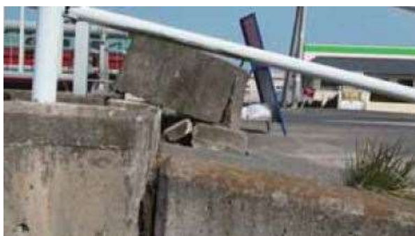
写真-1.2.48 橋台背面の沈下による段差（滑津橋） 27)
