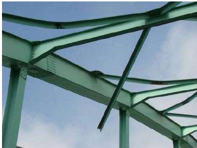
写真-1.2.42 トラス部（ガセット部）の破断（天王橋） 25)
