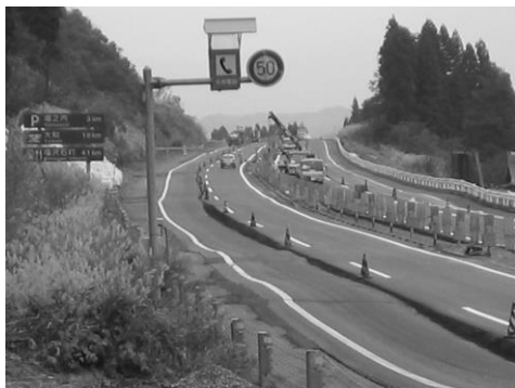
図-3 新潟県中越地震における片側1車線の舗装状況 5)
