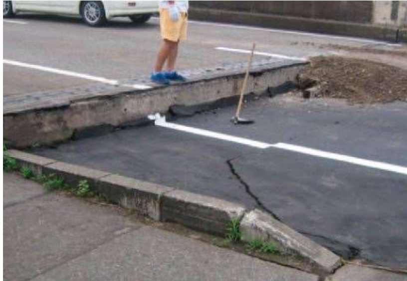
写真-1.2.29 橋面の段差被害（田沢川橋） 18)
