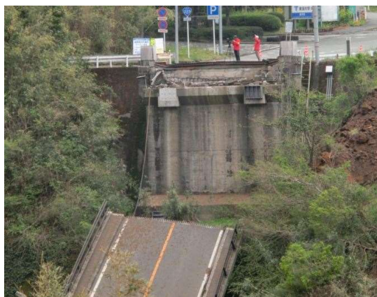
写真-1.2.56 上部構造の落橋状況（阿蘇大橋） 29)
