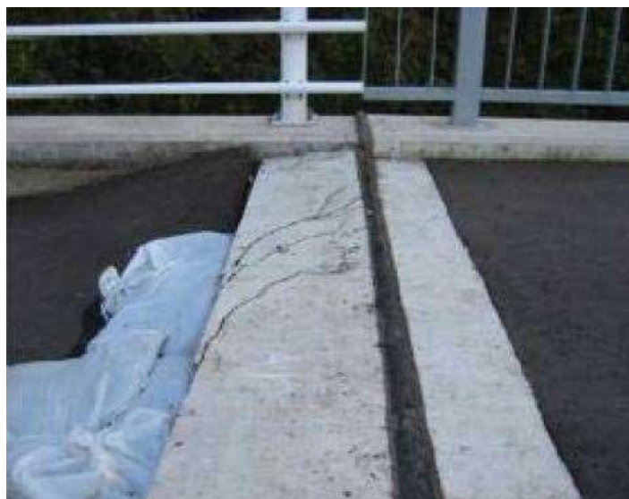
写真-1.2.5 橋台パラペットのひび割れ（観音橋） 12)
