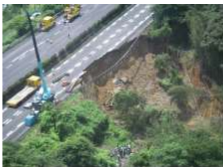
写真-1.1.53 牧之原地区での崩壊 23)
