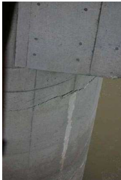
写真-1.2.7 可動支承を有する橋脚に発生したひび割れ（小千谷大橋） 12)
