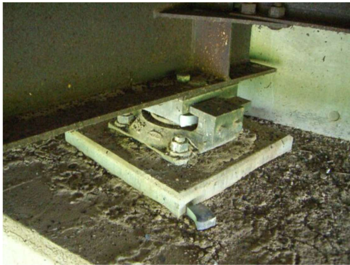
写真-1.2.22 支承上沓ストッパーの破断（吉井川橋） 20)
