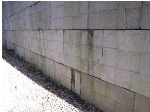
(a)壁面からの漏水
