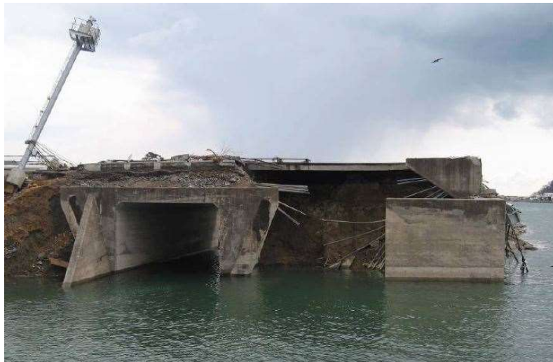
写真-1.2.37 橋台背面土の流出（気仙大橋） 25)
