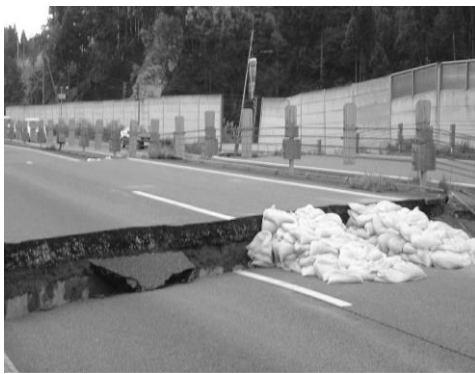
図-2 新潟県中越地震における路面段差と緊急的な復旧状況 5)
