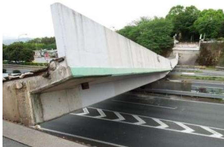
写真-1.2.58 落橋状況（府領第一橋） 29)
