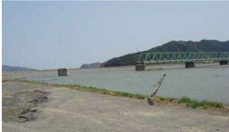
写真-1.2.44 上部構造の流出（新北上大橋） 28)
