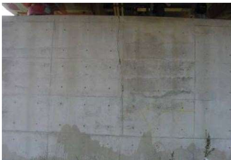
写真-1.2.10 橋脚の垂直ひび割れ（越の大橋） 12)
