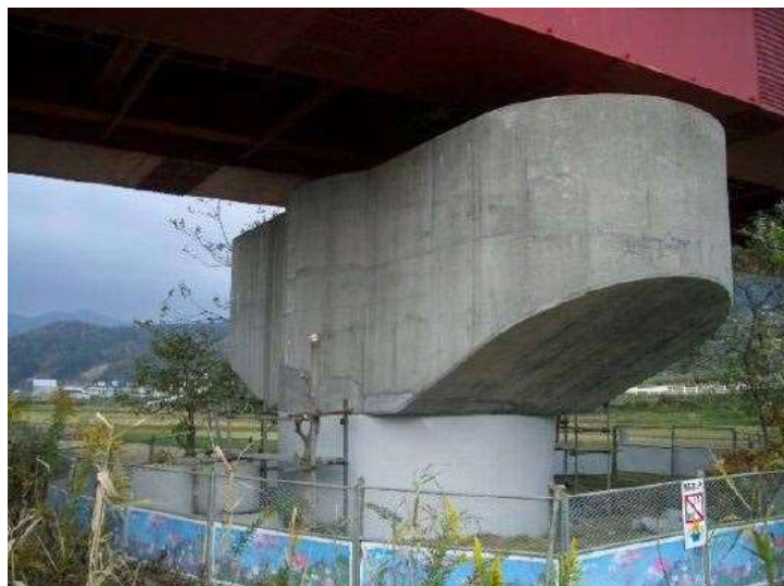
写真-1.2.8 炭素繊維シート巻き立てによる応急復旧（小千谷大橋） 12)
