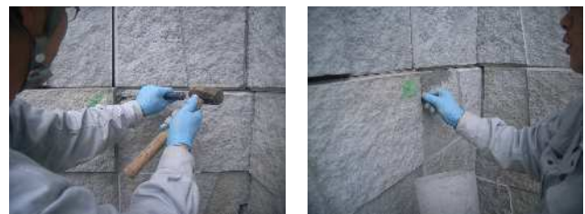
(a) 損傷部のはつり (b) 断面補修
