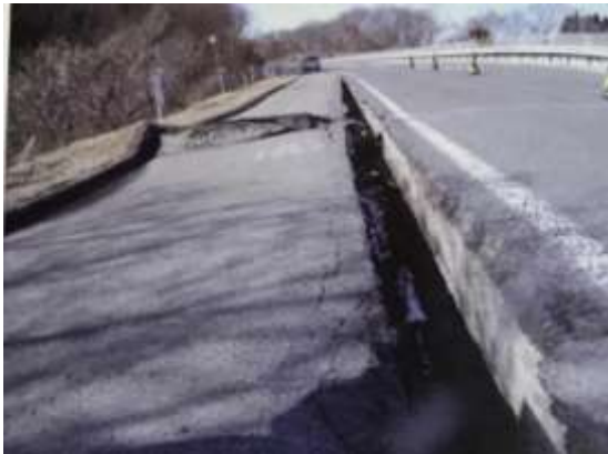
写真-1.1.60 166kp での被害状況 26)
