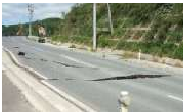
写真-1.1.50 胆沢トンネル西側での崩壊 21)
