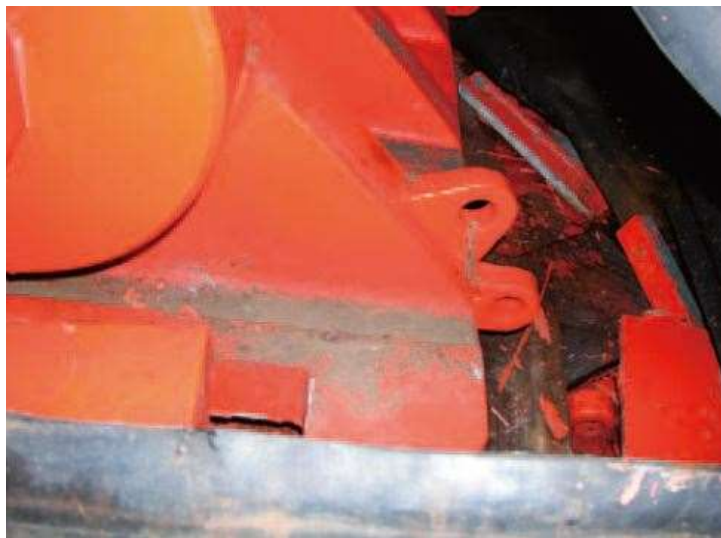
写真-1.2.27 可動支承ローラーの抜け出し（胞姫橋） 18)
