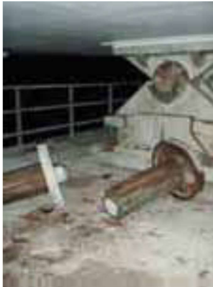
写真-1.2.18 ピンローラー支承のピンの切断（青海川橋） 17)
