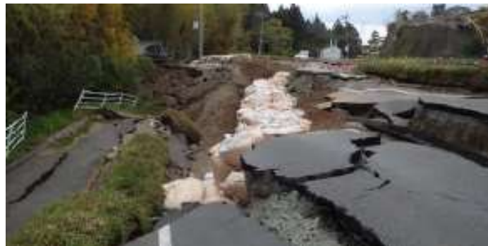
写真-1.1.74 寺迫交差点北側での崩壊 32)
