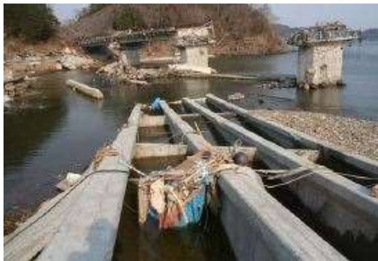
写真-1.2.35 流出した上部構造（歌津大橋） 26)
