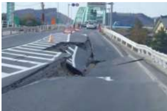
写真-1.1.71 石巻市鹿又付近での被害状況 29)
