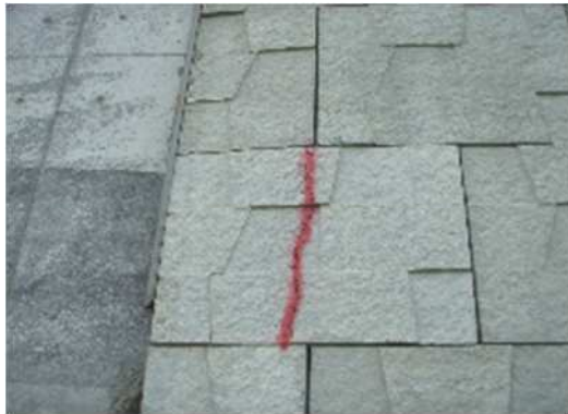
(b)壁面材の損傷
