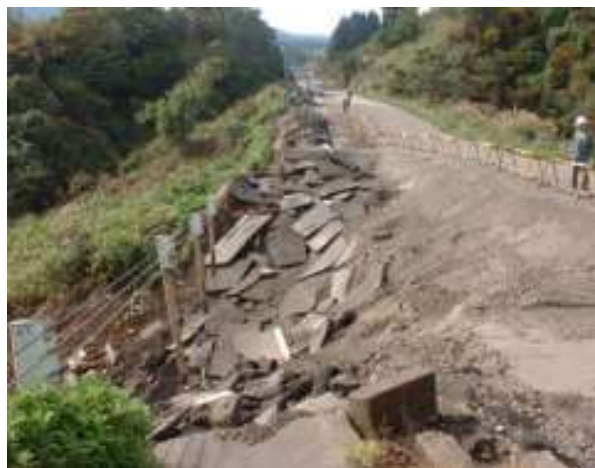
写真-1.1.13 小千谷市塩殿での崩壊 13)
