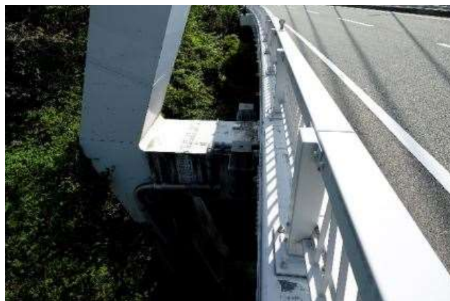
写真-1.2.59 上部構造の移動（桑鶴大橋） 31)
