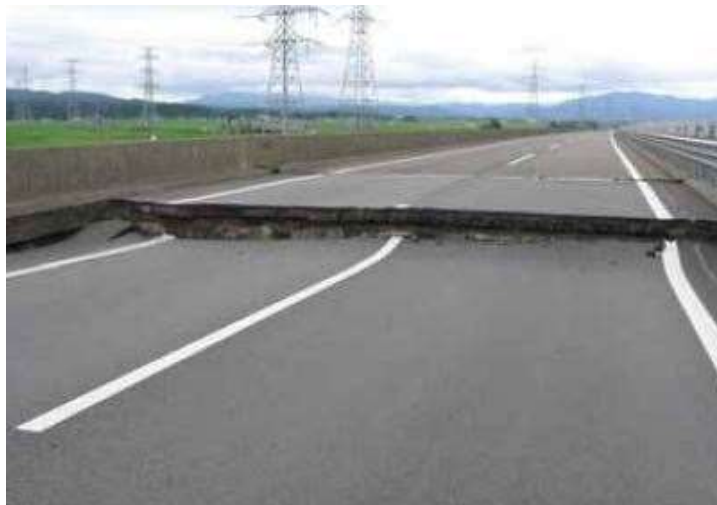
写真-1.2.23 橋面に発生した段差（吉井川橋） 21)
