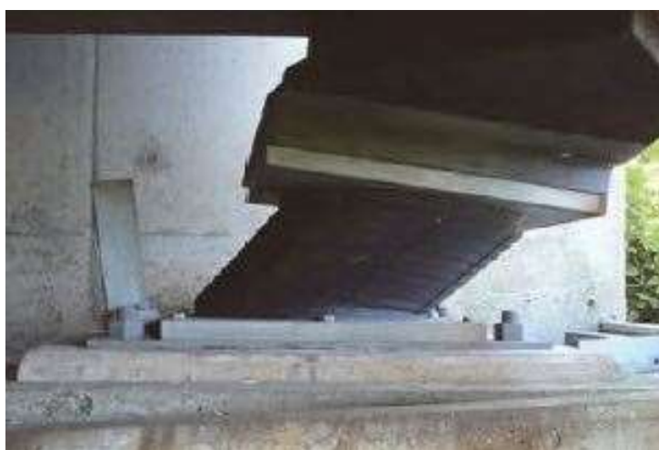
写真-1.2.63 ゴム支承の残留変形（扇の坂橋） 35)
