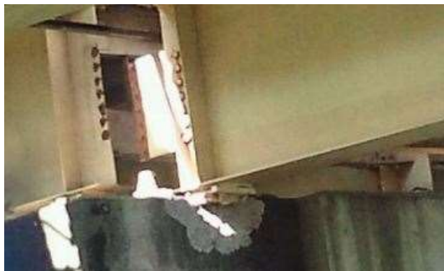
写真-1.2.52 橋梁桁の移動 (木山川橋) 30)
