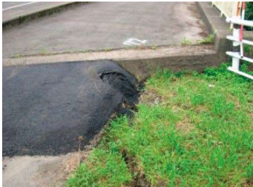
写真-1.2.30 橋面の段差被害（和田橋） 18)
