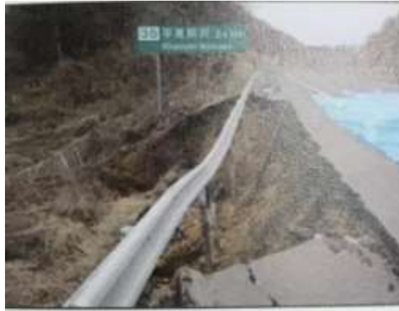
写真-1.1.63 434.3kp での被害状況 26)
