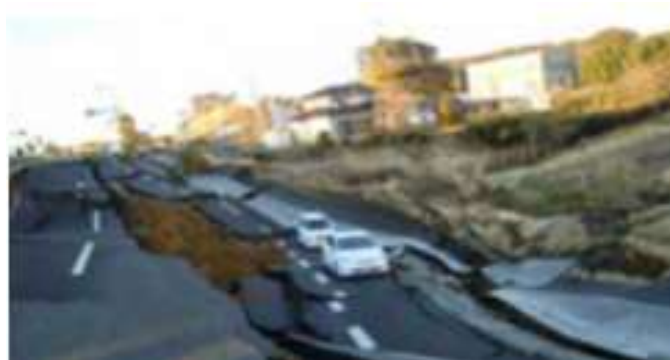
写真-1.1.69 双葉郡広野町付近での被害状況 29)
