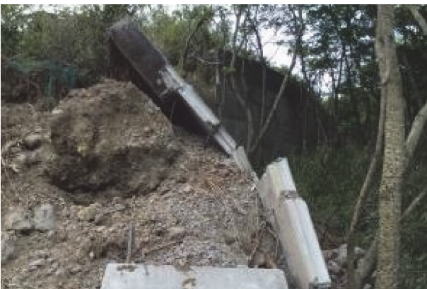
写真-2 補強土壁の被災事例 (損傷ランクV) 7)
