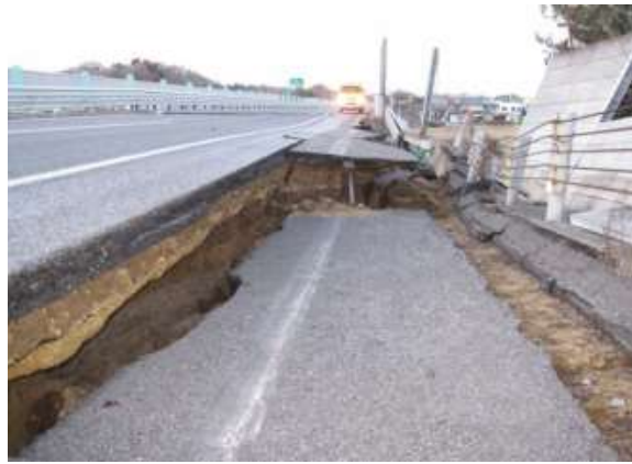
写真-1.1.61 197.6kp での被害状況 26)
