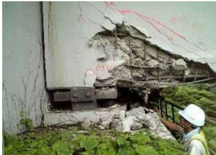
写真-1.2.19 桁端部下面でのせん断破壊（鉢崎橋） 18)
