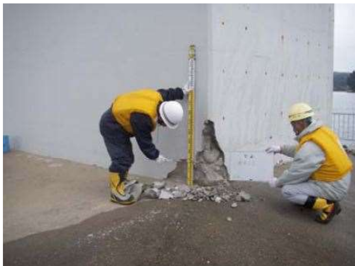
写真-1.2.17 P11 橋脚基部の損傷（能登島大橋） 16)
