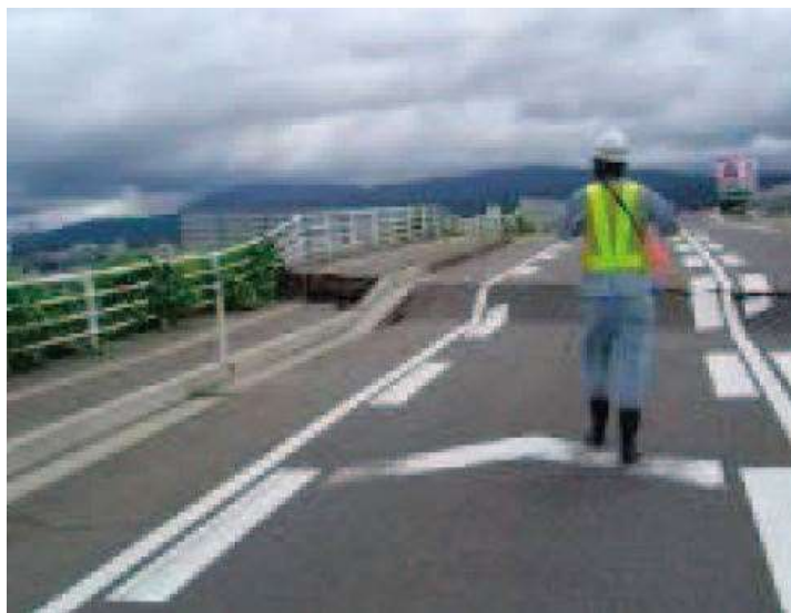
写真-1.2.24 橋面部の段差被害（比角跨線橋） 18)
