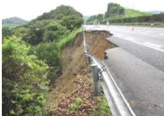
写真-1.1.54 牧之原地区での崩壊 23)
