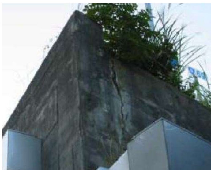
写真-1.2.4 橋台ウイング部のひび割れ（宮本橋） 12)
