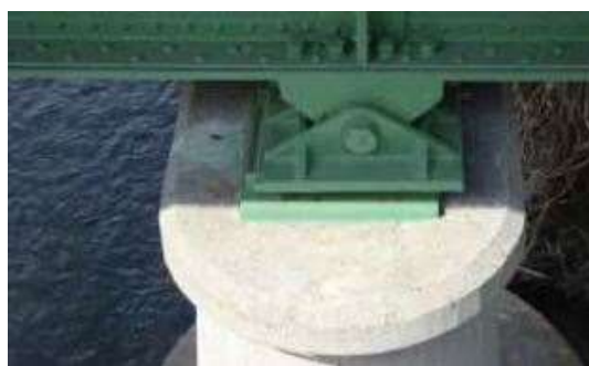
写真-1.2.49 支承部の移動（機初橋） 27)
