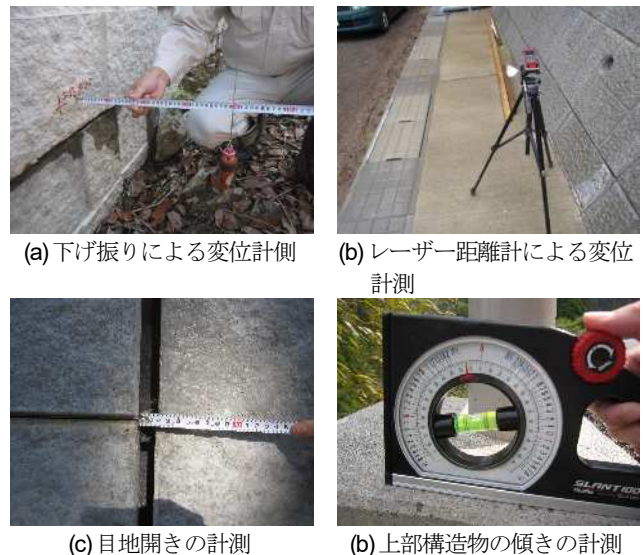
図-15 壁面に生じた変状の簡易な動態観測の例
