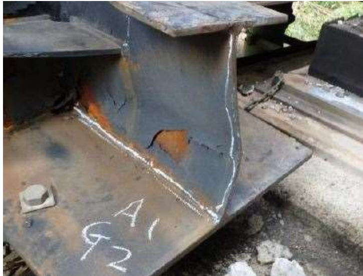
写真-1.2.65 主桁ウェブの座屈（大切畑大橋） 29)
