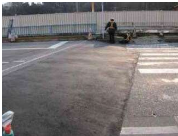
写真-1.2.46 橋台背面土の沈下による段差（平跨線橋） 27)
