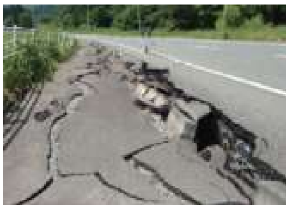
写真-1.1.52 栗原市松ノ原花山地区での被害 21)
