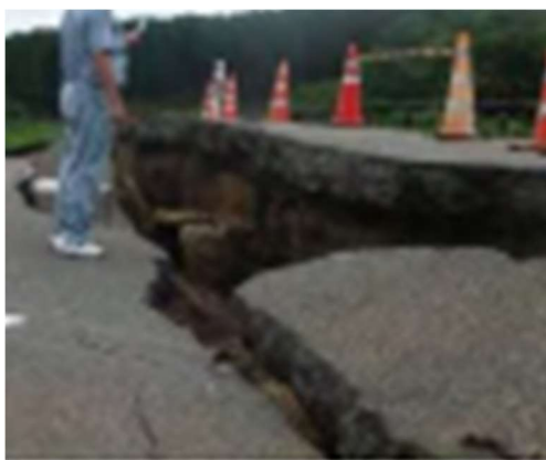
写真-1.1.47 柏崎市西山町尾野内での段差被害 20)
