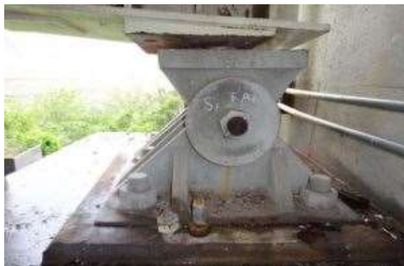
写真-1.2.54 セットボルトの脱落（並柳橋） 32)
