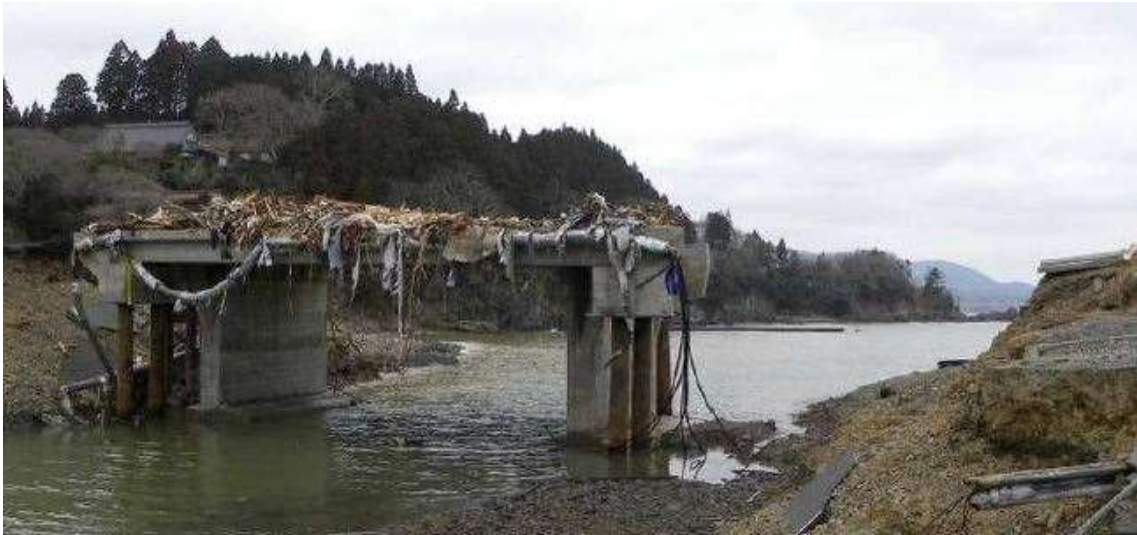
写真-1.2.36 橋台背面土の流出（二十一浜大橋） 25)
