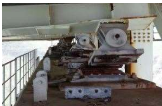
写真-1.2.55 主桁部と支承部の分離（並柳橋） 32)
