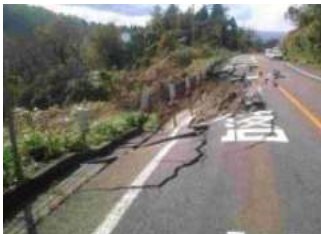
写真-1.1.19 長岡市乙吉町での崩壊 17)
