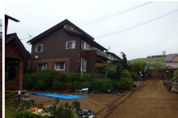
崩壊地下部の住宅は震動による被害は確認されない
