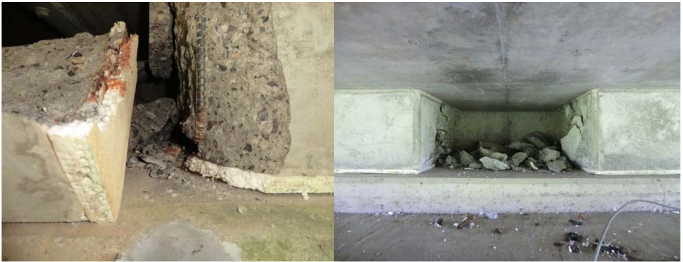
変位制限構造のコンクリートブロックの破損 A1, A2両方で発生
