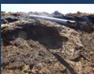
崩壊土砂の中にあつた塩ビ管
