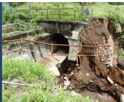
導水路の破損・漏水箇所
