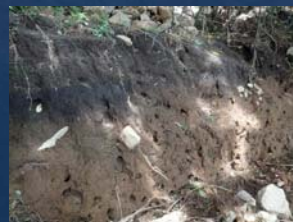
小規模崩壊滑落崖のパイピング痕
