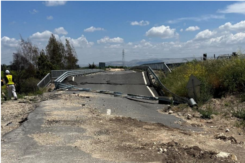
橋台の回転に伴う沈下(通行止め)
