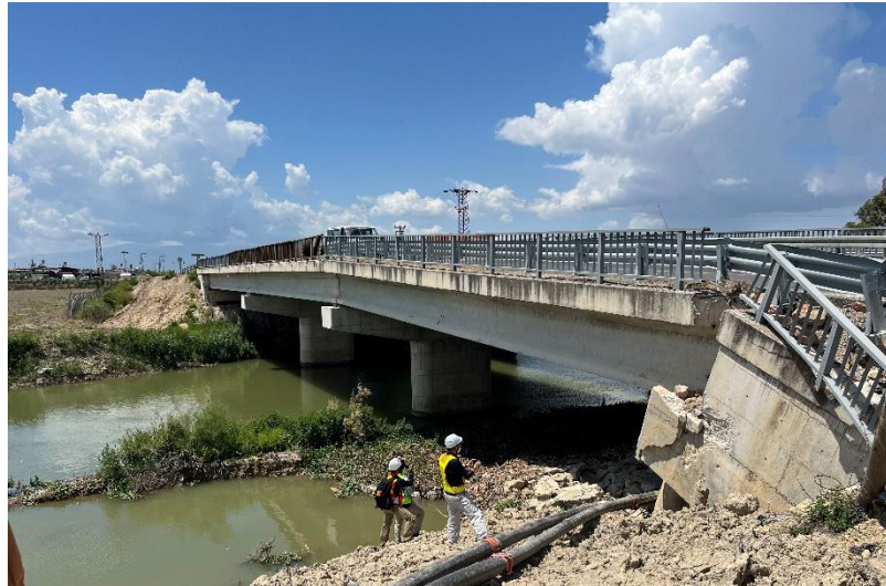
橋台の回転に伴う沈下(通行可)
