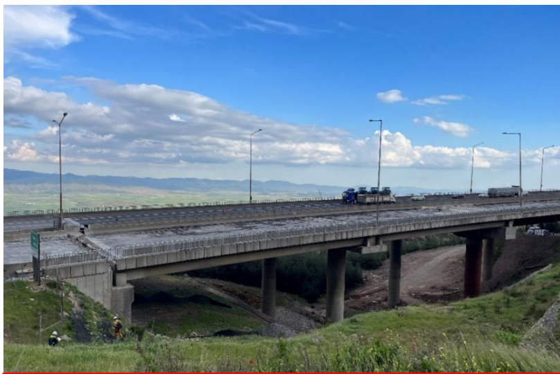
谷側 : 対面通行 山側 : 通行止め
