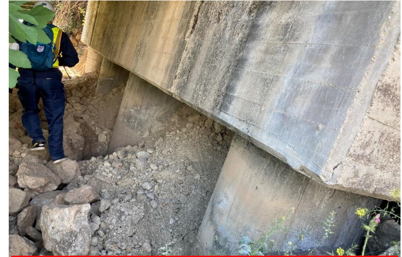
杭頭が露出しているが損傷は無い
