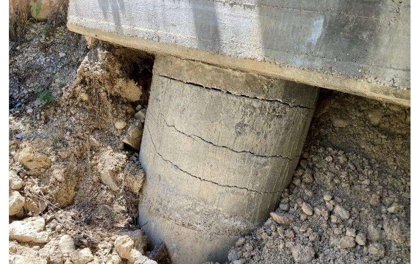
一部の杭で，杭頭に曲げひび割れ
